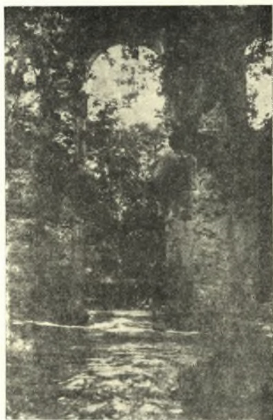
Εἰκ. 17. Καμάρα τοῦ ὕδραγωγείου τῆς Νικοπόλεως ὑπὲρ τὸν ροῦν τοῦ ποταμοῦ Λούρου.
