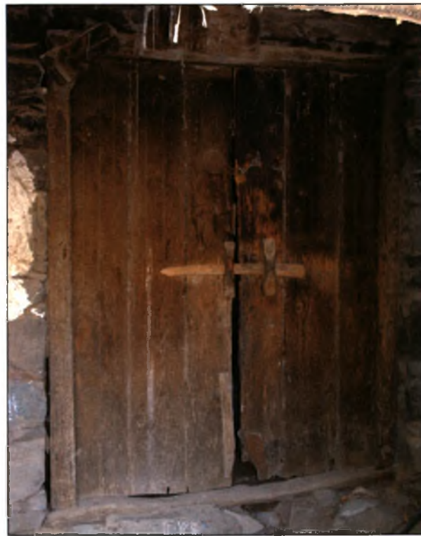
Εικόνα 75 : Μερική αποσάθρωση μικρών τμημάτων ξυλείας στο κάτω μέρος, γήρανση και παρουσία ρίπων.
