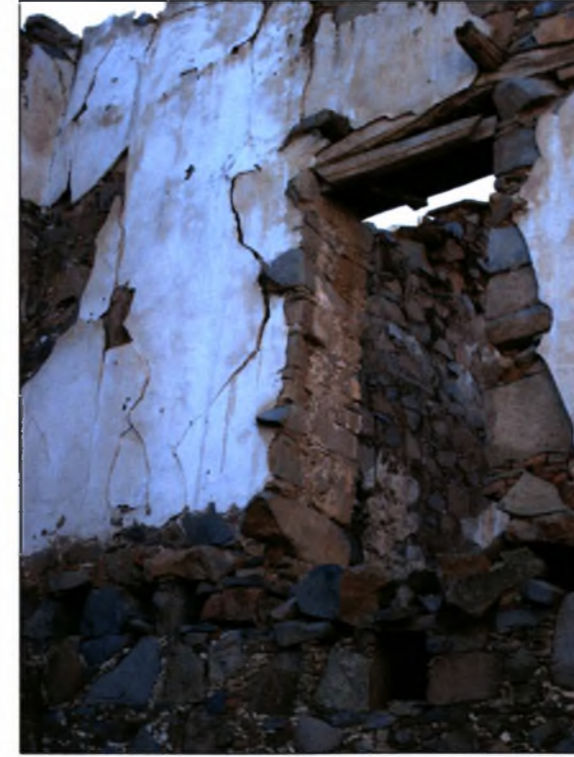
Εικόνα 98 : Η επικάλυψη έχει καταστραφεί, και υπάρχουν ρωγμές .
