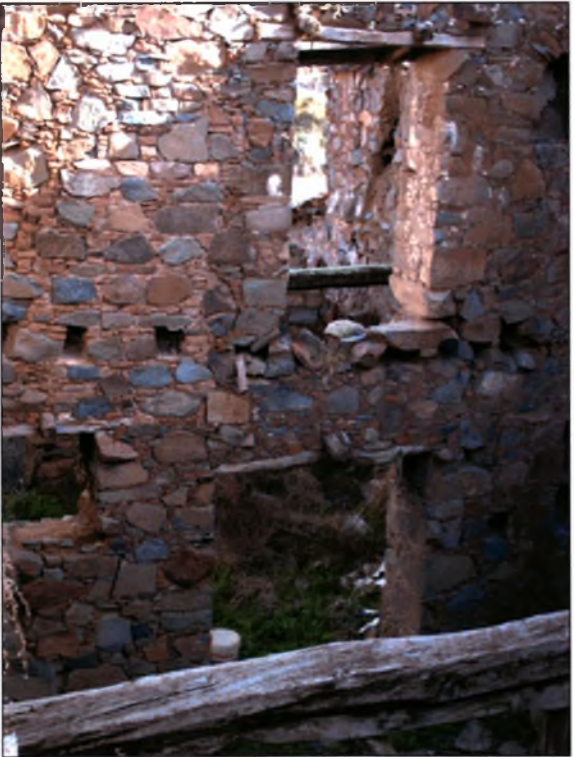
Εικόνα 94 : Καταστροφή πατώματος και κουφωμάτων
