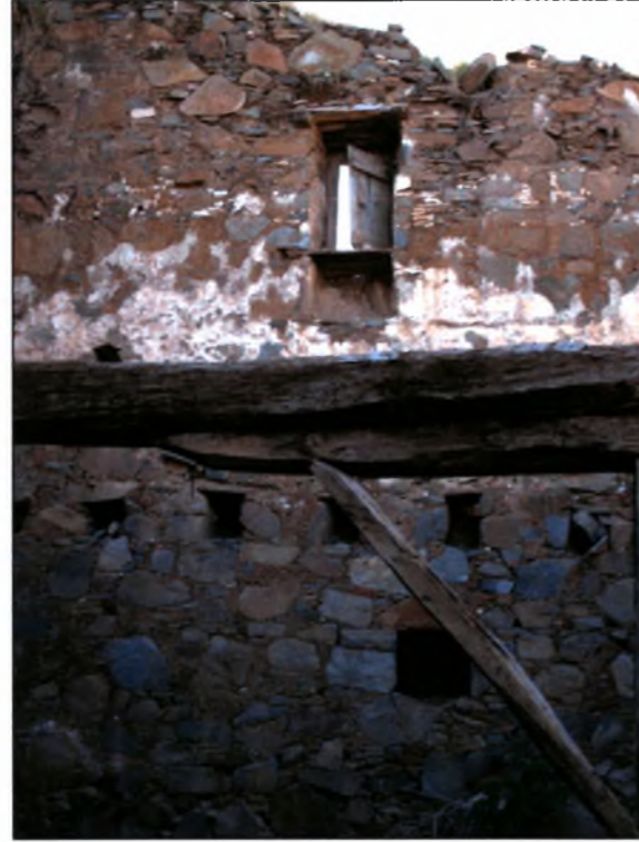
Εικόνα 93 : Η στέγη και το πάτωμα έχει καταστραφεί και η ξυλεία έχει υποστεί γήρανση.
