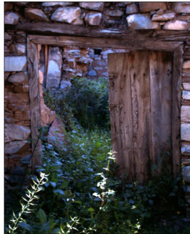
Εικόνα 86 : Τα κουφώματα έχουν υποστεί γήρανση, έχουν παραμορφωθεί από την αυξημένη άσκηση κατακόρυφων φορτίων, ενώ μέρος τους έχει παρουσιάσει μερική αποσάθρωση ξυλείας.
