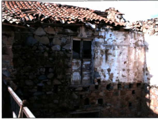
Εικόνα 83 : Ένα μέρος της στέγης έχει καταστραφεί εντελώς, υπάρχει απώλεια και μετατόπιση των κεραμιδιών.
