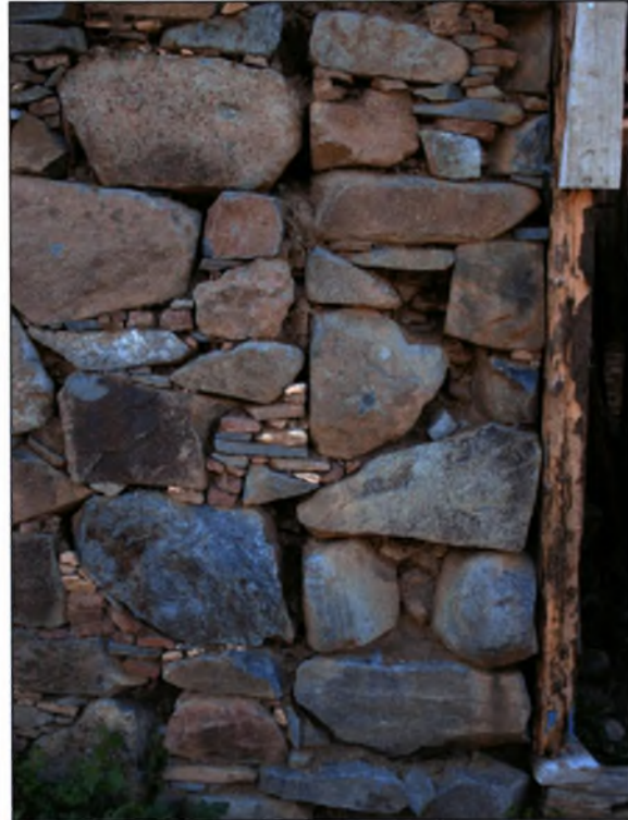
Εικόνα 64 : Αρμός μεταξύ των μαντρότοιχων που μας δηλώνει ότι χτίστηκε πρώτα η οικία Ζαχαρίου και μετά έχουμε την ολοκλήρωση της οικίας Χαραλάμπους Χ.
