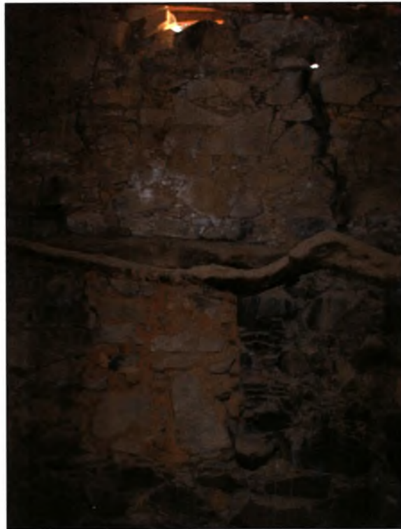
Εικόνα 81 : Ρίπτοι και διαμπερείς ρωγμές, εύρους 1-10 εκ.
