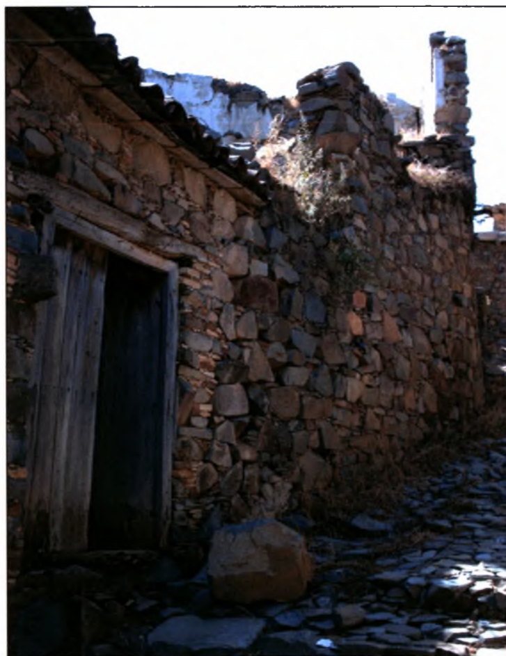
Εικόνα 90 : Εμφανή τα σημάδια αποσάθρωσης του κονιάματος, της επιφανειακής διάβρωσης κονιάματος και της ολικής καταστροφής του πάνω μέρους όλων των λιθοδομών. Σε ένα σημείο έχει υποστεί απόκλιση
