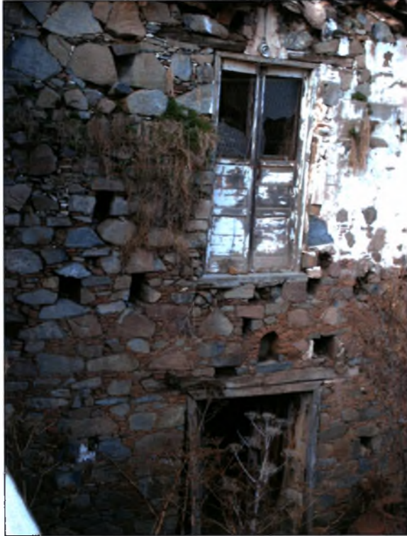
Εικόνα 79 : Επιφανειακή διάβρωση στο πάνω μέρος και αποσάθρωση του κονιάματος.
