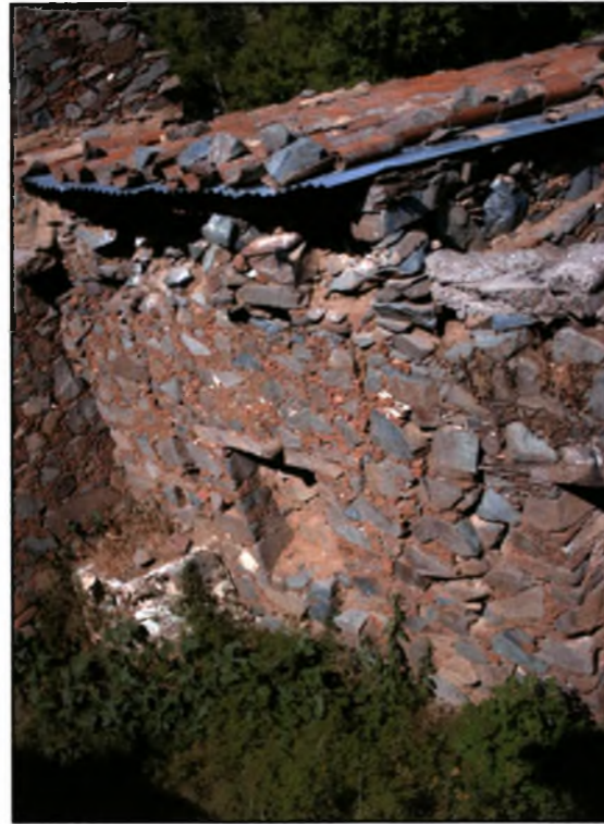
Εικόνα 82 : Επιφανειακή διάβρωση, και διαμπερείς ρωγμές, εύρους από 1-10 εκ
