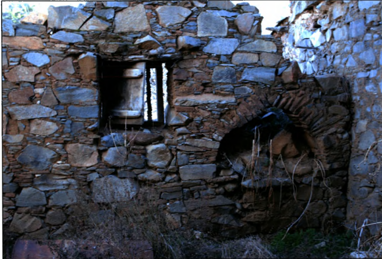
Εικόνα 66 : Αρμός που δηλώνει ότι κτίστηκε η οικία Ζαχαρίου Α. και πάνω σε αυτήν ενσωματώθηκε η οικία Μιχαηλίδη.
