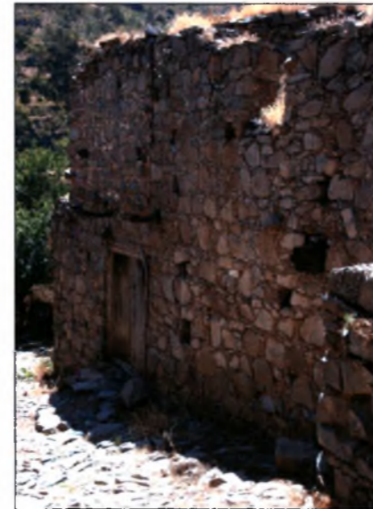
Εικόνα 41 : Καταστραμμένος όροφος. Οικία Μιχαηλίδη Κώστα.
