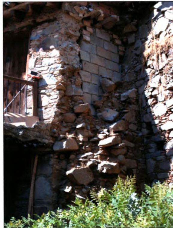
Εικόνα 71 : Καταστρεμμένος τοίχος όπου ο ιδιοκτήτης αντικατέστησε την πέτρινη λιθοδομή με τούβλα
