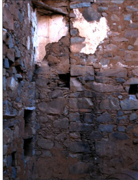
Εικόνα 65 : Αρμός που δηλώνει ότι κτίστηκε η οικία Ζαχαρίου Α. και πάνω σε αυτήν ενσωματώθηκε η οικία Μιχαηλίδη Κ.
