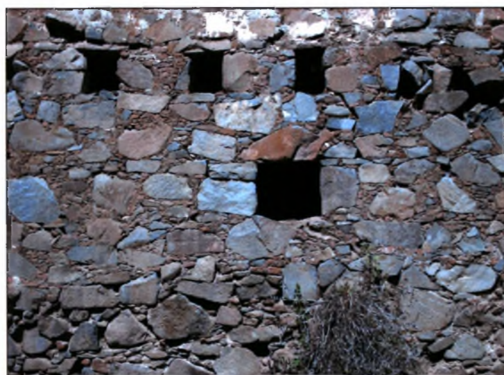
Εικόνα 91 : Αποσάθρωσης του κονιάματος.
