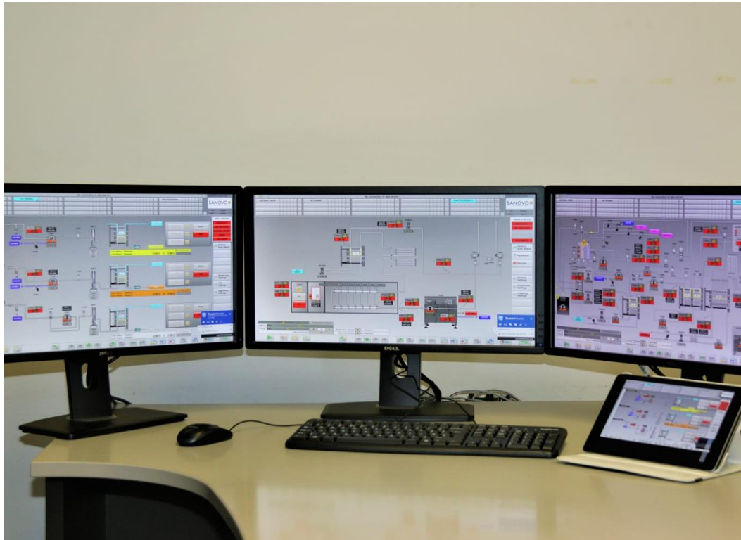
Εικόνα 12 Κέντρο Ελέγχου Συστήματος SCADA ( https://www.sanovoegg.com/products/processing-solutions/supervision-system/scada-automation )
