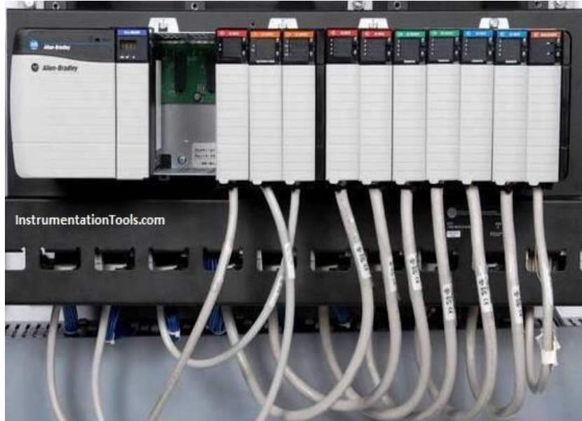
Εικόνα 27 RTU Συστήματος SCADA ( https://instrumentationtools.com/scada-hardware-and-software )
