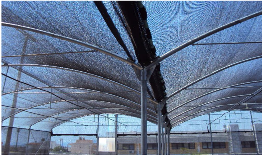
Εικόνα 4 Μεταλλικός γαλβανισμένος σκελετός του διχτοκηπίου του Τμήματος ΓΥΠΠ
