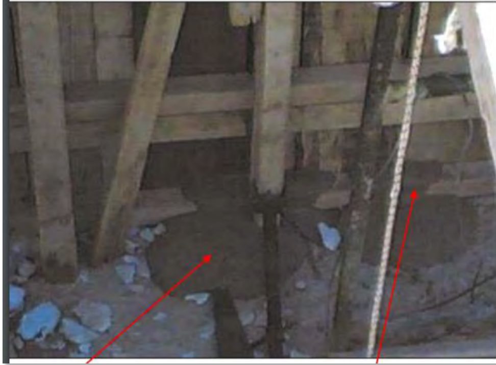
Εικόνα 4.8: Διαρροή σκυροδέματος από ξυλότυπους [πηγή: ημερίδα ΤΕΕ Βογιατζής (2008)]
