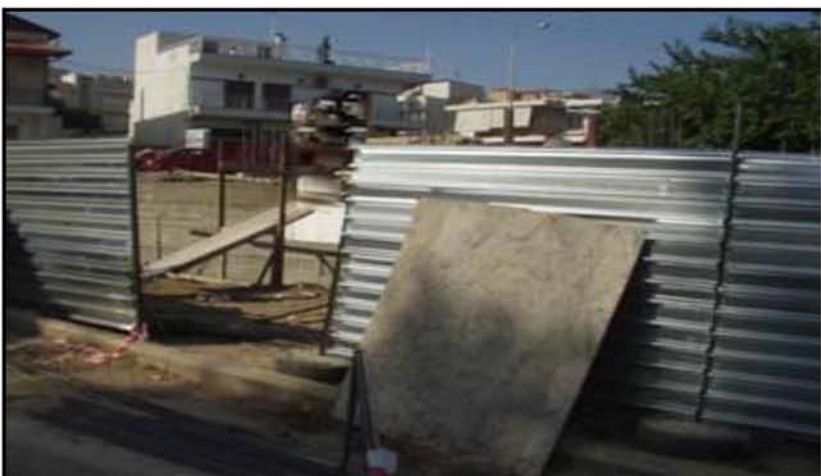
Εικόνα 2: Παράδειγμα περίφραξης κτηρίων (στην εικόνα βλέπουμε την περίφραξη ενός κτηρίου που είναι υπό ανέγερση) έχει εκδοθεί άδεια κατάληψης του πεζοδρομίου και απαιτείται προστατευτικό στέγασμα.)
