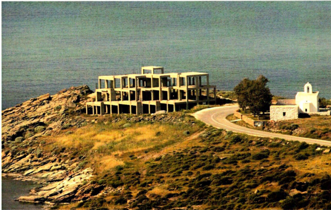
(Αυθαίρετη κατασκευή στη Τζιά)
