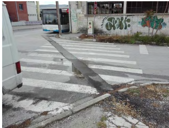
Εικόνα 18: Διάβαση πεζών και κατάσταση πεζοδρομίων στην οδό Αλαμάνας
