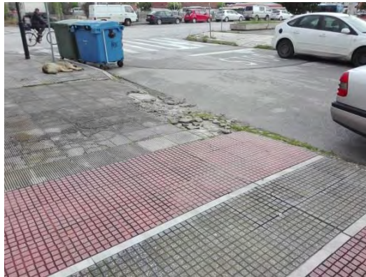
Εικόνα 22: Σπασμένες πλάκες πεζοδρομίου στην οδό Αλαμάνας
