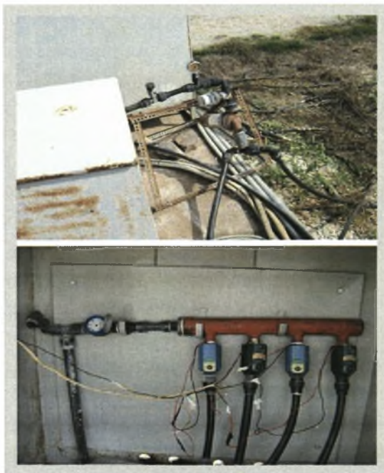
ΕΙΚΟΝΑ 2.5: Η κεφαλή ελέγχου με το φίλτρο δίσκων, τη βαλβίδα εκτόνωσης, τις ηλεκτροβάννες τροφοδοσίας των μεταχειρίσεων και το κεντρικό υδρόμετρο.
