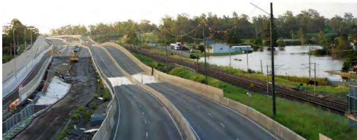
Εικόνα 15 Καταστροφές που προκλήθηκαν στον αυτοκινητόδρομο Ipswich ( http://www.flickr.com )
