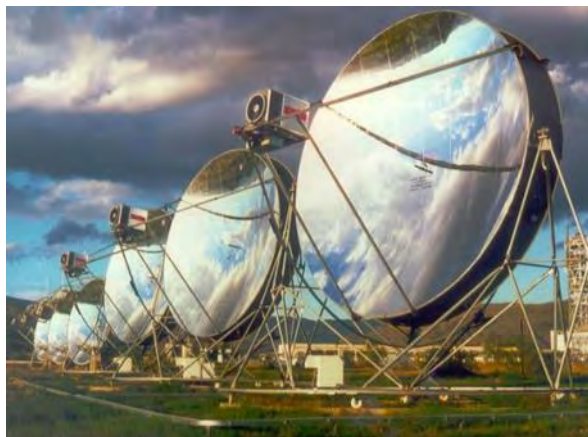
Σχήμα 1.5 Έξι παραβολικοί «δίσκοι-πιάτα» στο ερευνητικό κέντρο της Plataforma Solar De Almeria [10].
