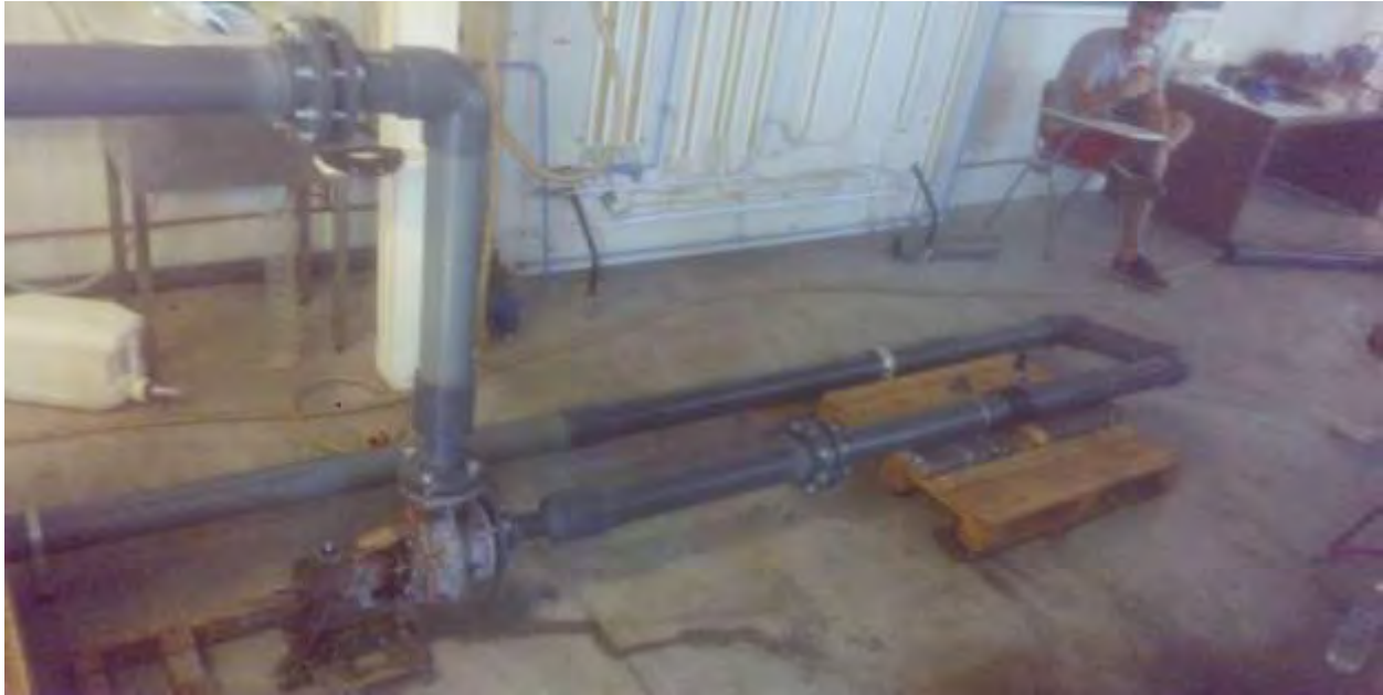
64. Το δίκτυο συνδεδεμένο στην PAT και ο αγωγός επιστροφής στη δεξαμενή
