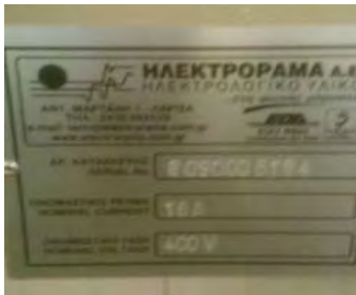
16. Ηλεκτρολογικός Πίνακας Λεπτομέρειες
