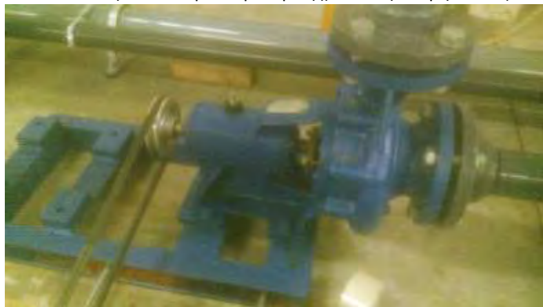
116. Τροχαλία εγκατεστημένη στον άξονα της αντλίας
