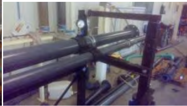
69. Μανόμετρο στον αγωγό
