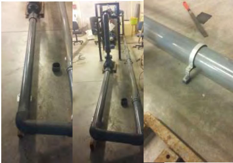
61. Γωνίες για επιστροφή στη δεξαμενή
