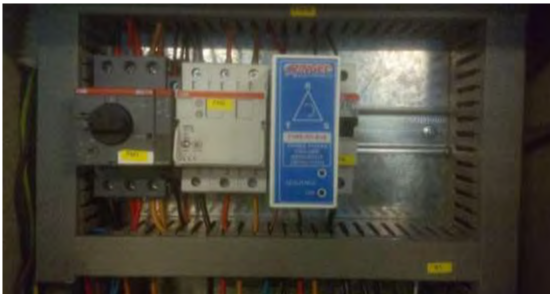
18. Θερμομαγνητικός Διακόπτης, Ασφαλειοαποζεύκτης Φορτίου, Επιτηρητής Τάσης
