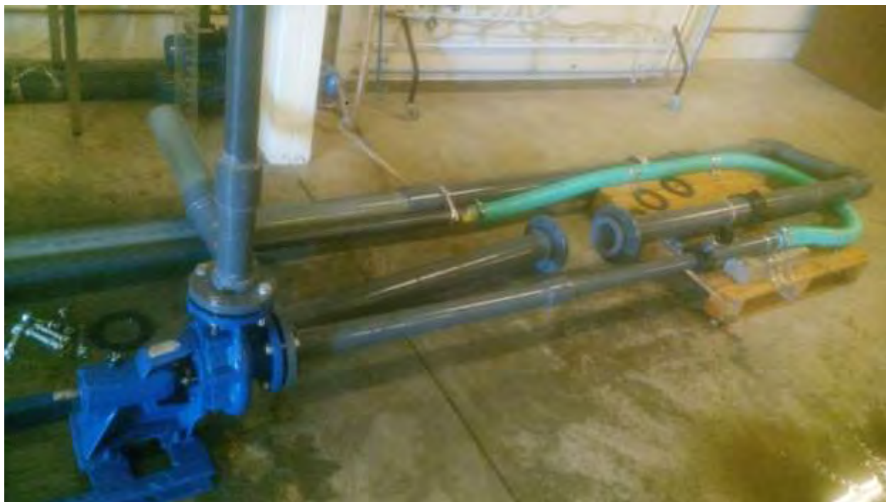
72. Ο αγωγός Φ63 (2.5") συνδεδεμένος με την PAT και τον αγωγό επιστροφής
