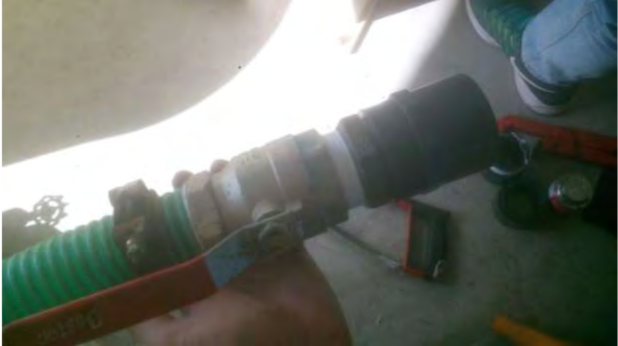
115. Σύνδεση αγωγού με λάστιχο που καταλήγει στην αποχέτευση
