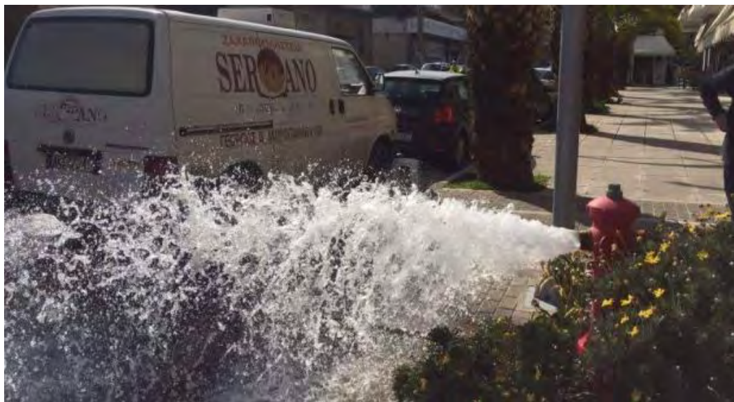
Εικόνα 2-2: Διαδικασία έκπλυσης μέσω πυροσβεστικού κρουνού
