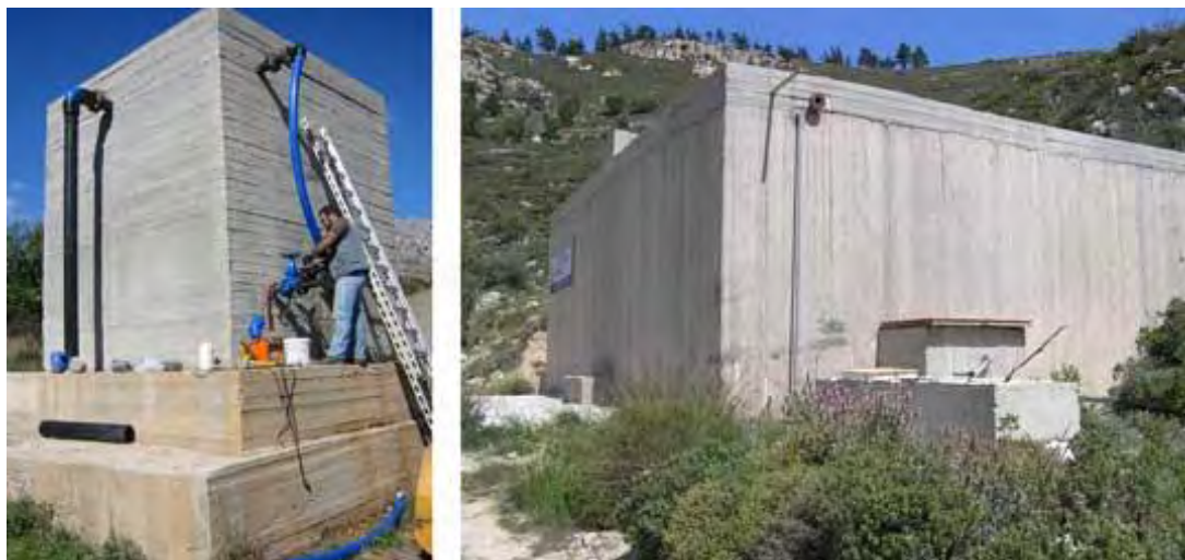
Εικόνα 2-4: Δεξαμενή υδροδότησης μεγάλης κλίμακας
