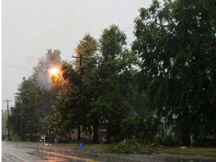
Εικόνα 2.1: Βραχυκύκλωμα στις γραμμές μεταφοράς ηλεκτρικής ενέργειας
