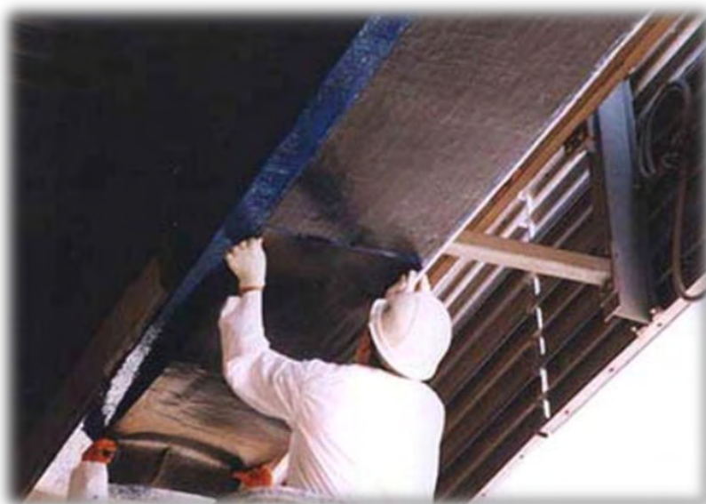
Σχήμα 2- 12:Ενίσχυση δομικού μέλους με ελάσματα από σύνθετα υλικά από ινοπλισμένα πολυμερή (Βαρδακαστάνης, Δομικοί έλεγχοι)
