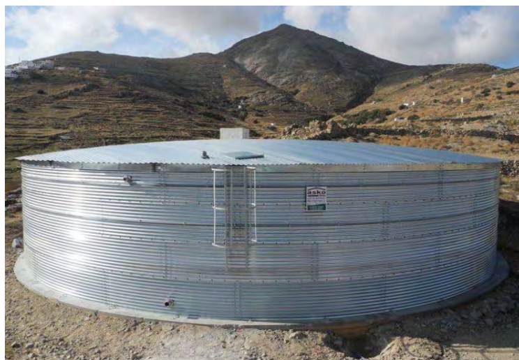
Σχήμα 1.1.9: Δεξαμενή αποθήκευσης νερού στο νομό Αργολίδας (Πηγή: argonafplia.gr).
