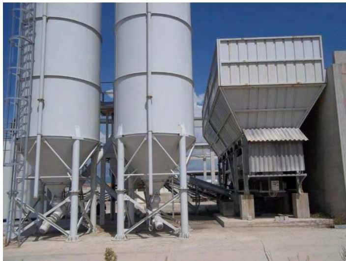
Σχήμα 2.4: Χώρος αποθήκευσης τσιμέντου (σιλό)
