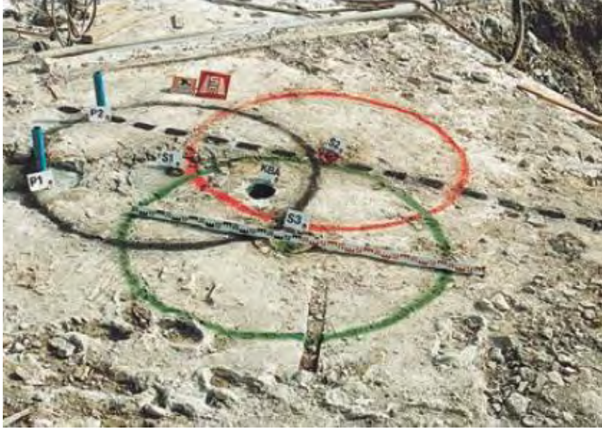
Σχήμα 3.13: Σχεδιασμός του εκτιμώμενου εύρους και διάστασης των πασσάλων από την επιφάνεια της εκσκαφής
