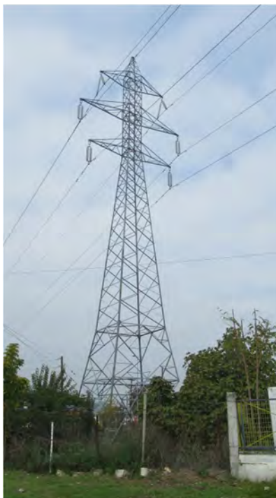
Εικόνα 1.3.8.1: Μεταλλικός πυλώνας υψηλής τάσης ΔΕΗ
