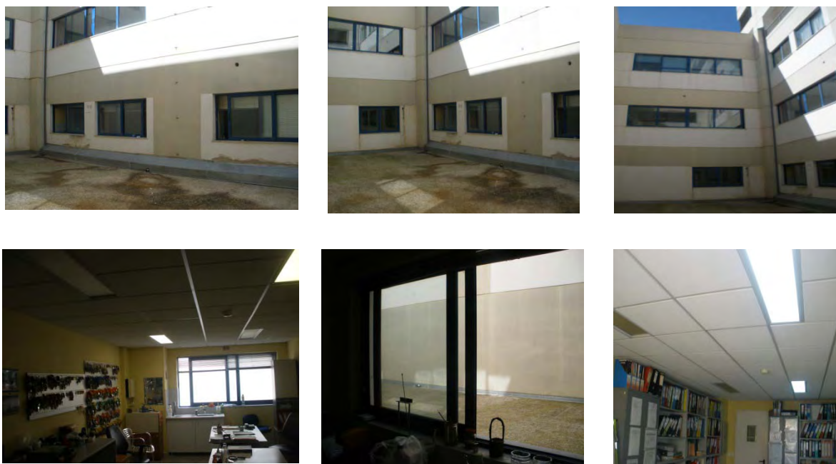
Εικόνα 32. Εσωτερική και εξωτερική όψη των χώρων των Γραφείων – Εργαστηρίων των υπό μελέτη χώρων της Τ.Υ. του Γ.Ν. Λαμίας
