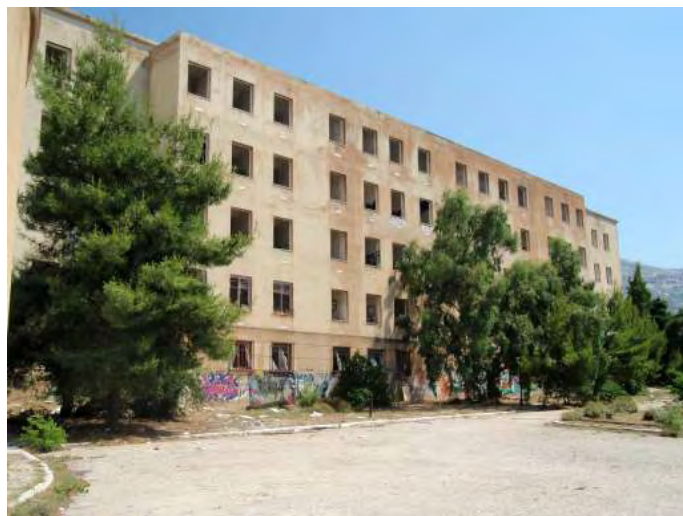
Εικόνα 61. Ματιές στις εγκαταλεημένες εγκαταστάσεις του Ν.Ι.Ε.Θ.
