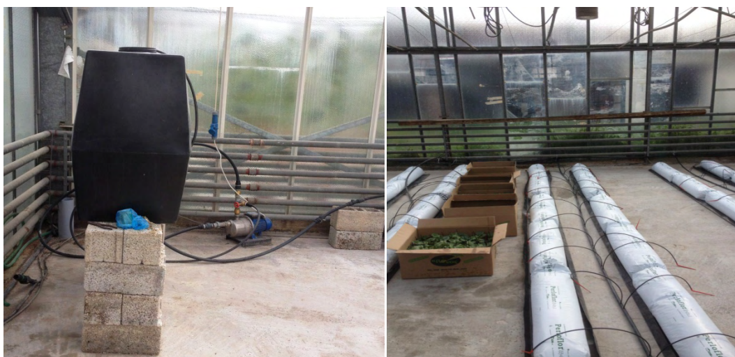
Εικόνα 2.3 Δεξαμενή, αντλία νερού, σωληνώσεις πολυαιθυλενίου, σταλάκτες
