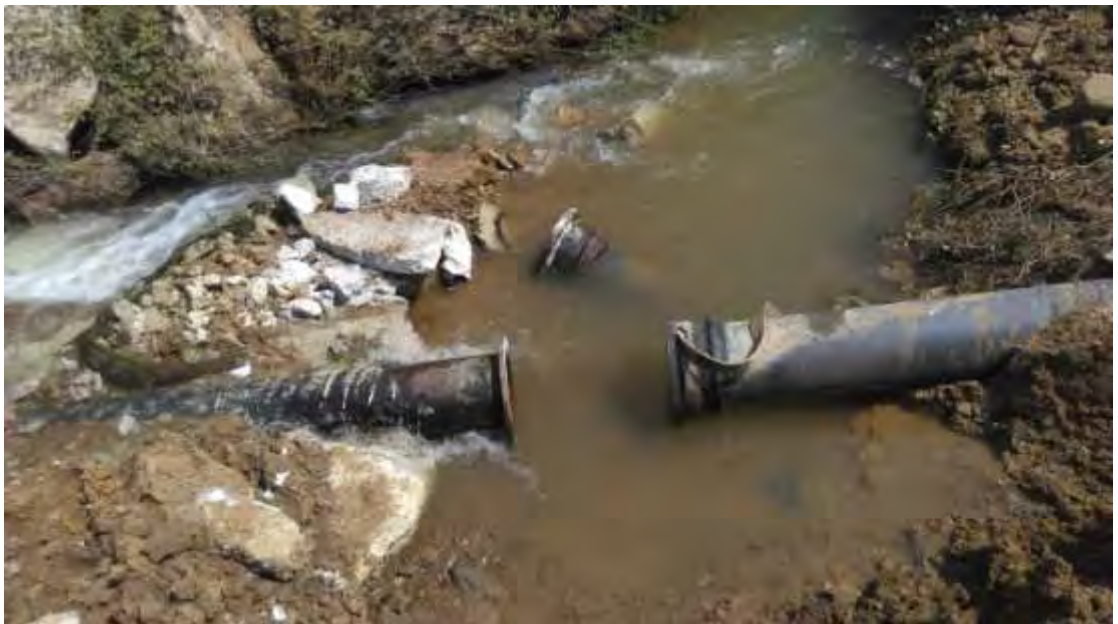
Εικόνα 5.39 βλάβη 13η διάρρηξη αγωγού στη ζώνη Σ4
