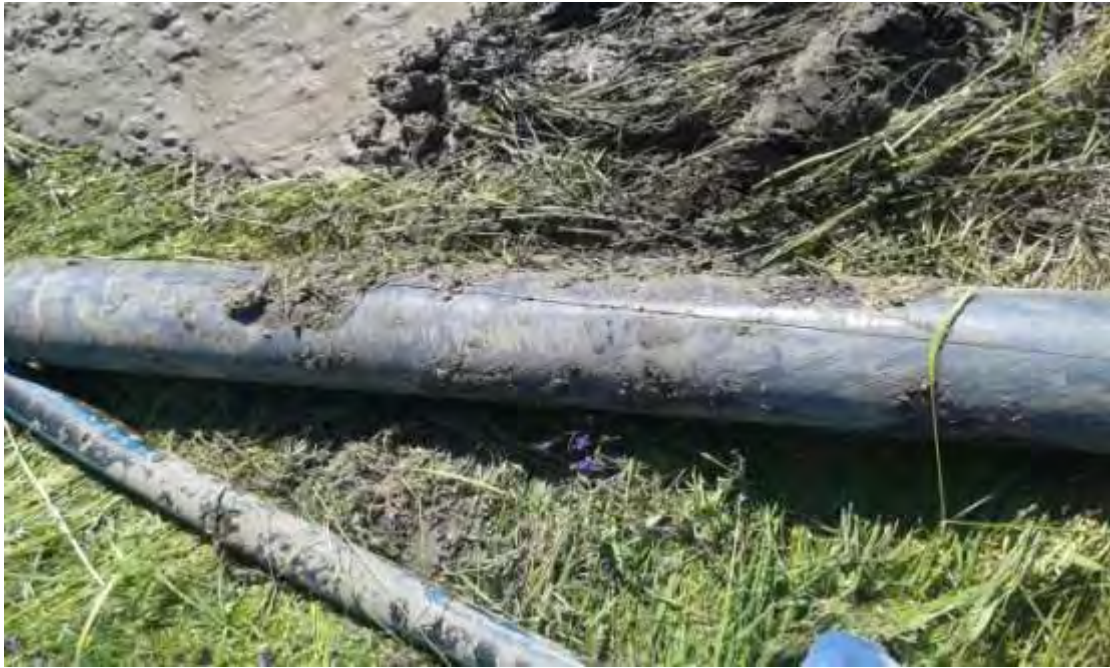
Εικόνα 5.4 βλαβη 4η διαρρυξη αγωγού στη ζώνη Σ2
