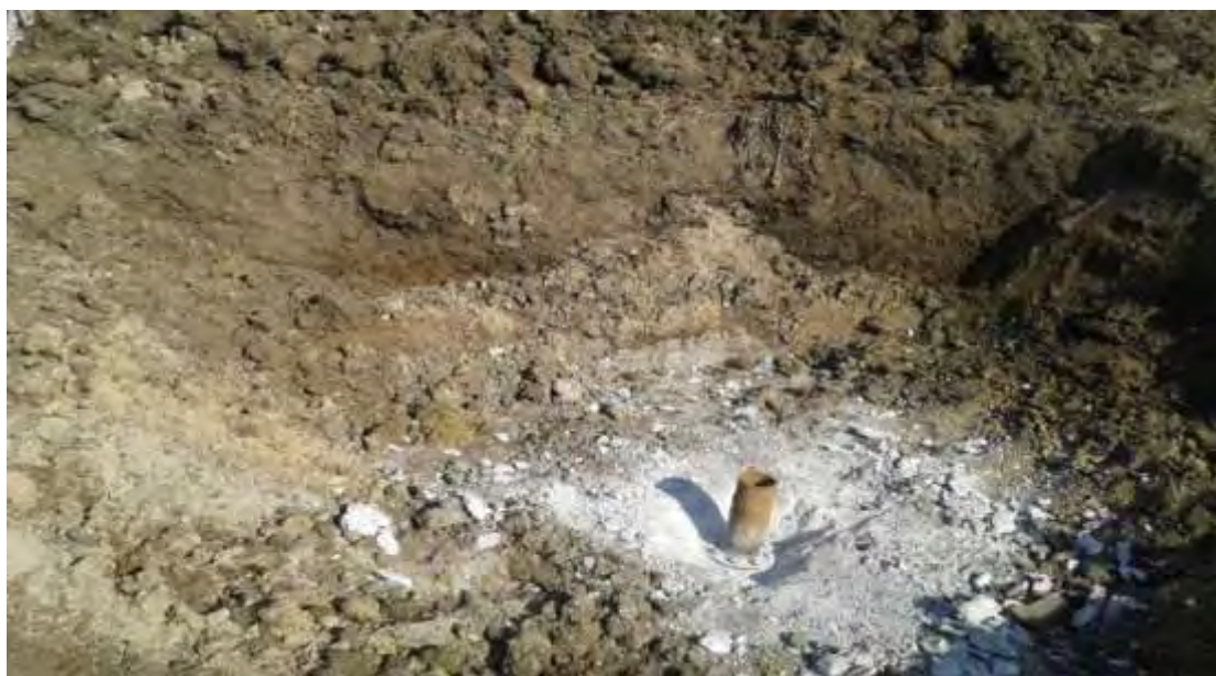
Εικόνα 5.17 βλαβη 5η διαρρηξη αγωγου στη ζώνη Σ2
