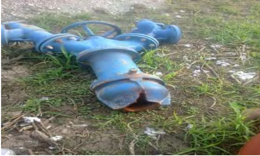
Εικόνα 5.2 βλάβη 2 η σπάσιμο υδροληψείας στη ζώνη Σ2
