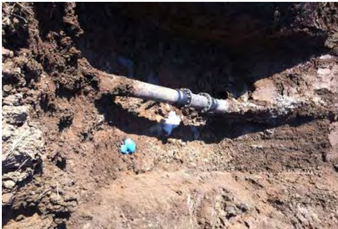
Εικόνα 5.26 βλαβη 14η διάρρηξη αγωγού στη ζώνη Σ3
