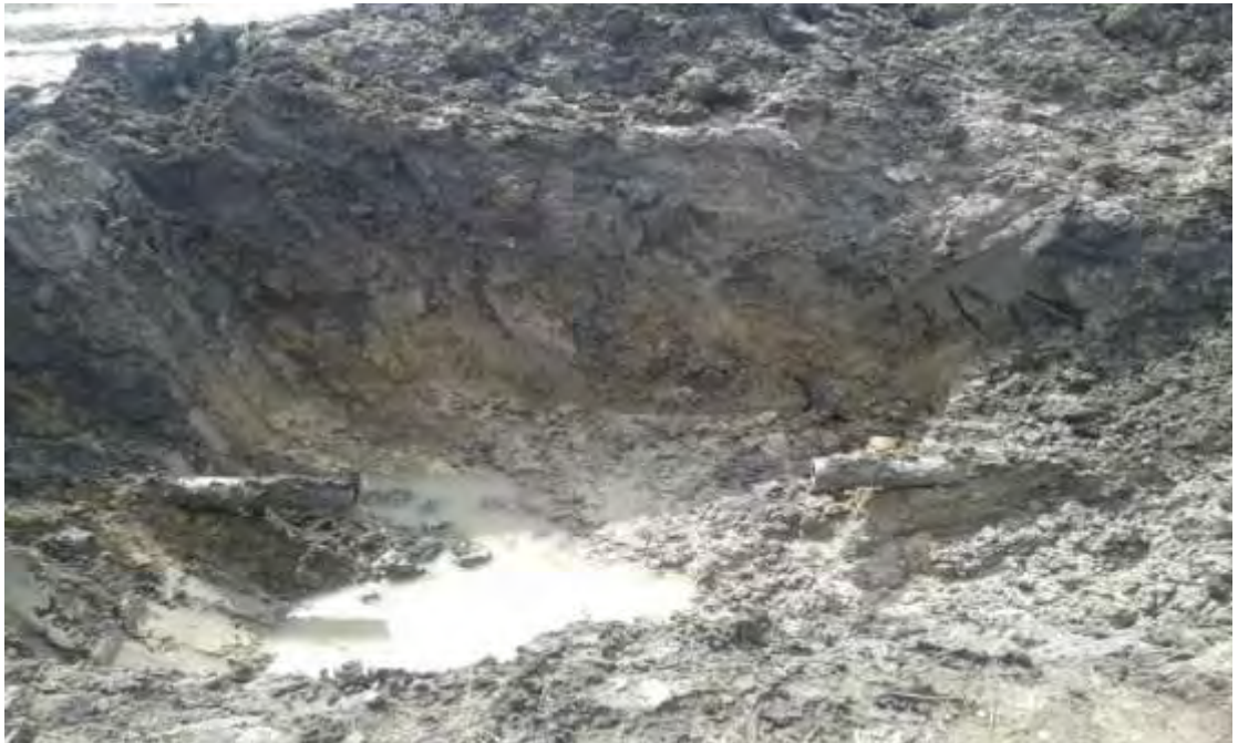
Εικόνα 5.34 βλάβη 8η διάρρηξη αγωγού στη ζώνη Σ2
