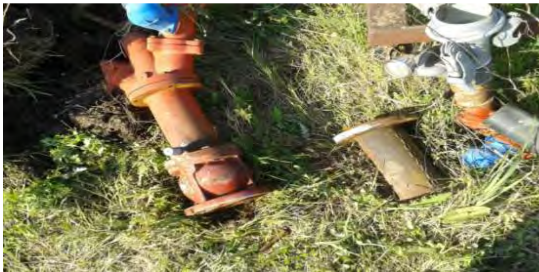
Εικόνα 5.16 βλαβη 4η διαρρηξη αγωγου στη ζώνη Σ2
