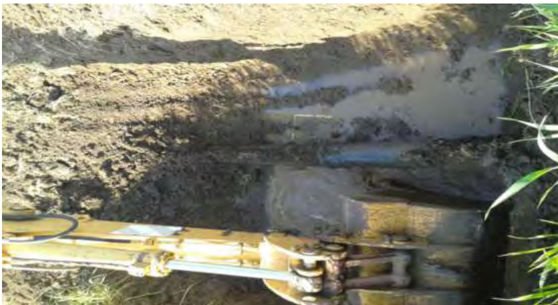
Εικόνα 5.15 βλαβη 3η διαρρηξη αγωγού στη ζώνη Σ4
