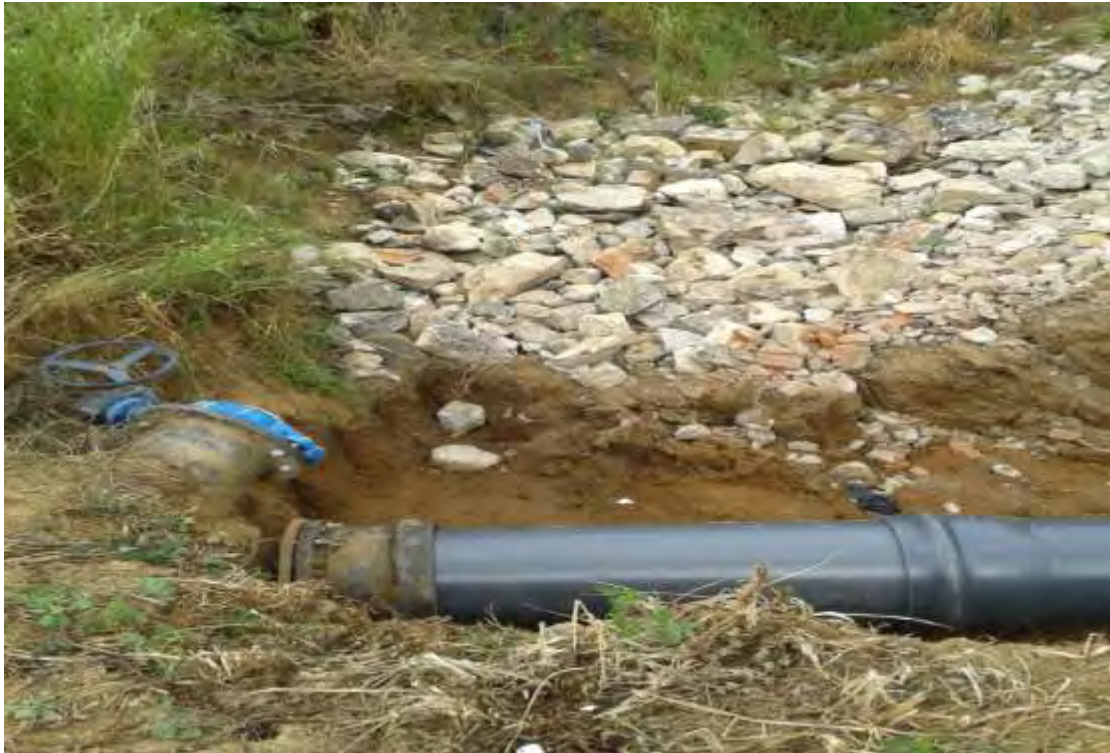
Εικόνα 5.1 βλάβη 1 η διαρροξη αγωγου στη ζώνη Σ2
