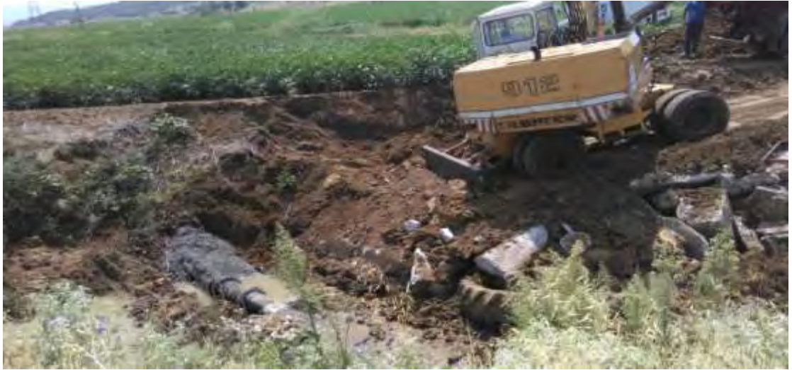
Εικόνα 5.38 βλάβη 12η διάρρηξη αγωγού στη ζώνη Σ2
