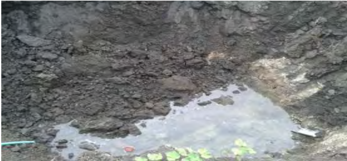
Εικόνα 5.9 βλαβη 9η διαρρηξη αγωγου στη ζώνη Σ3
