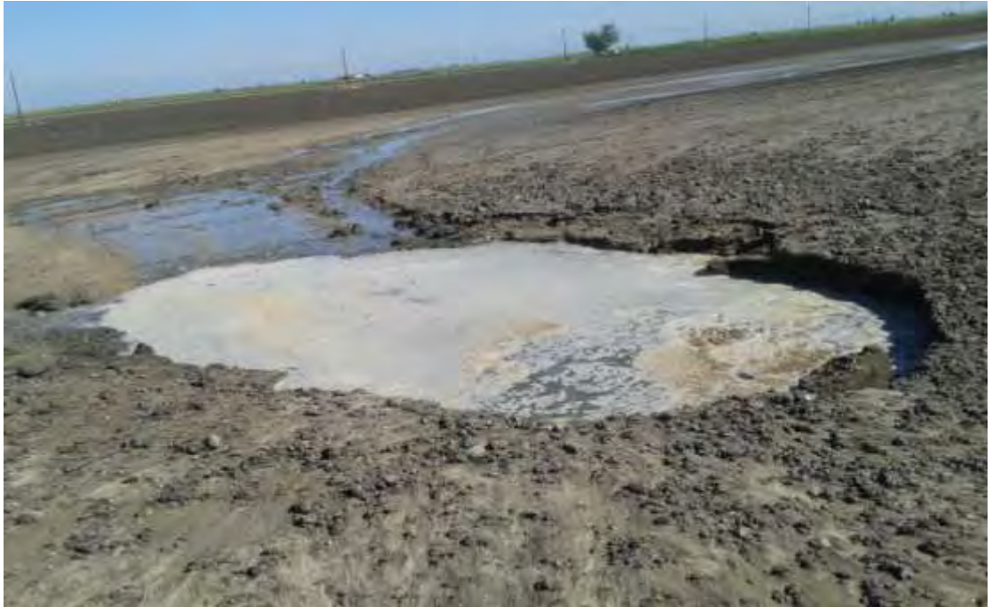
Εικόνα 5.30 βλαβη 4η διάρρηξη αγωγού στη ζώνη Σ3
