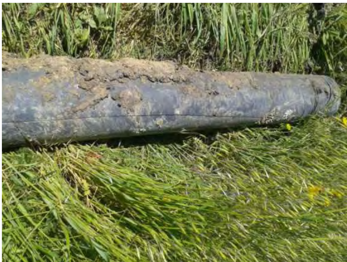
Εικόνα 5.31 βλάβη 5η διάρρηξη αγωγού στη ζώνη Σ3
