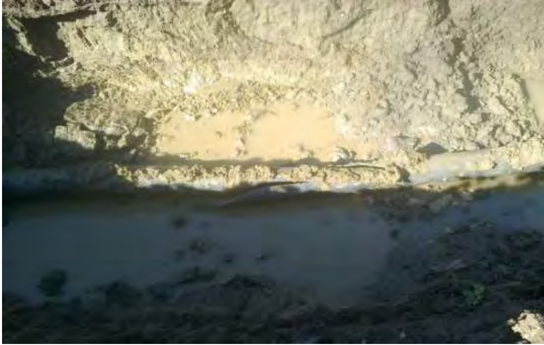
Εικόνα 5.11 βλαβη 11η διαρρηξη αγωγου στη ζώνη Σ3
