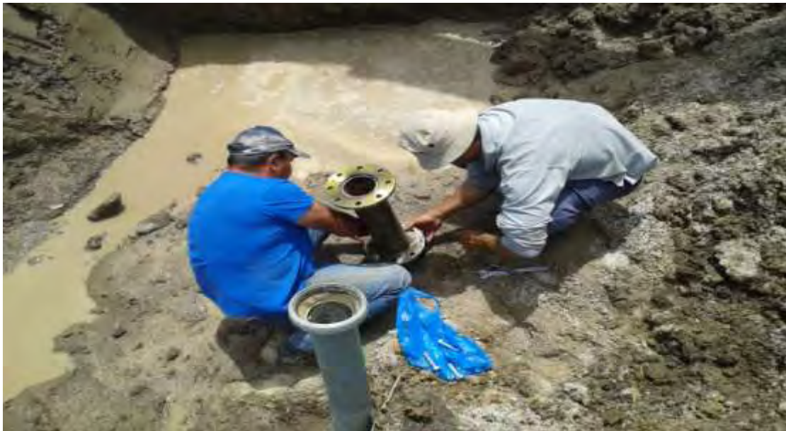
Εικόνα 5.21 βλαβη 9η διαρρηξη αγωγου στη ζώνη Σ3
