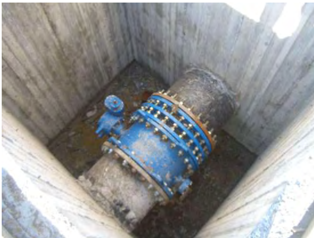
Εικόνα 4.2: Φρεάτιο κλειστού αγωγού Σ2
