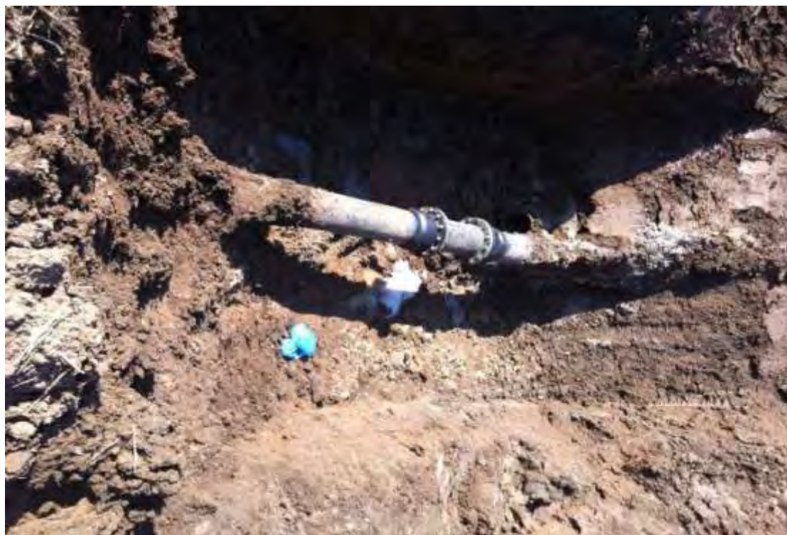
Εικόνα 5.26 βλαβη 14η διάρρηξη αγωγού στη ζώνη Σ3
