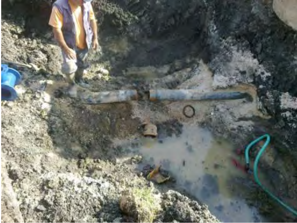
Εικόνα 5.8 βλαβη 8η διαρρηξη αγωγου στη ζώνη Σ4
