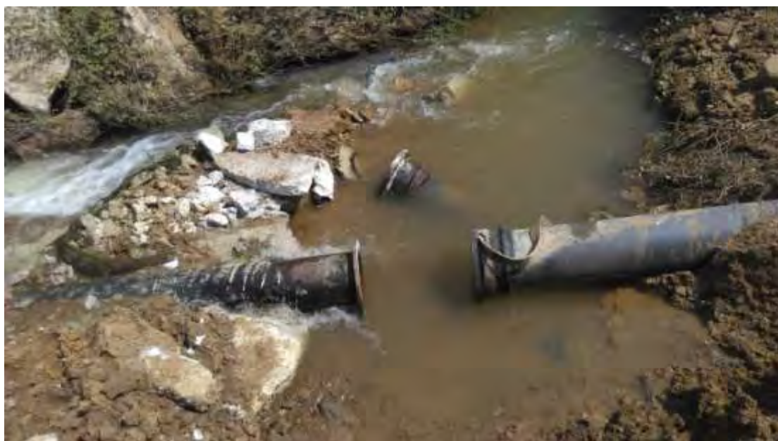
Εικόνα 5.39 βλάβη 13η διάρρηξη αγωγού στη ζώνη Σ4
