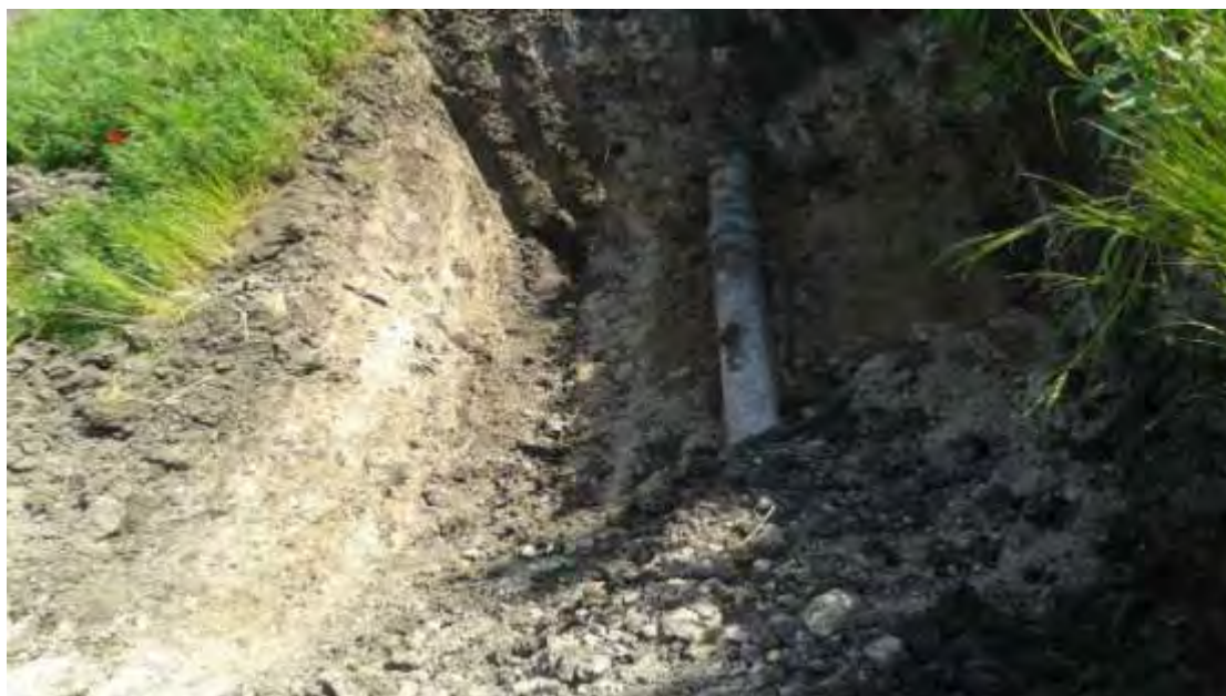
Εικόνα 5.13 βλαβη 1η διαρρηξη αγωγου στη ζώνη Σ4
