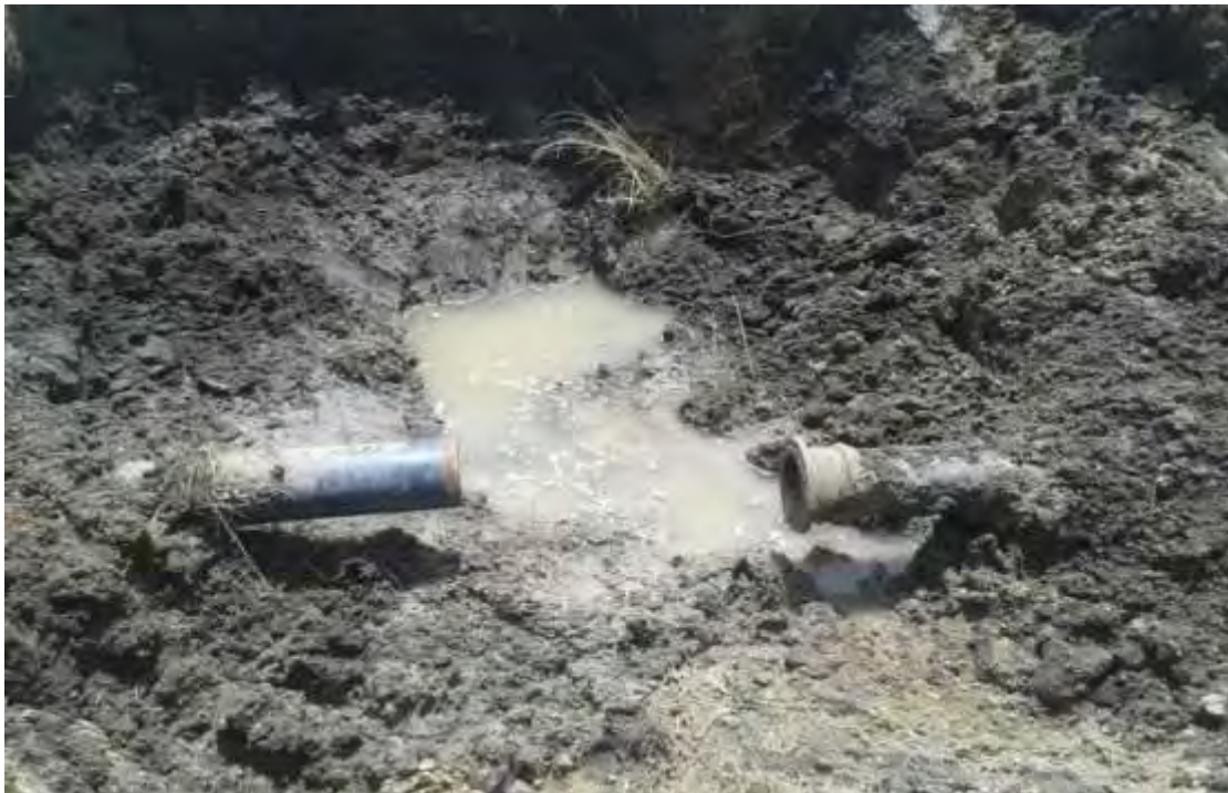
Εικόνα 5.10 βλαβη 10η διαρρηξη αγωγου στη ζώνη Σ3
