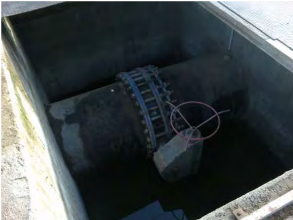
Εικόνα 4.1 :Φρεάτιο κλειστού Σ3-Σ4 αγωγού
