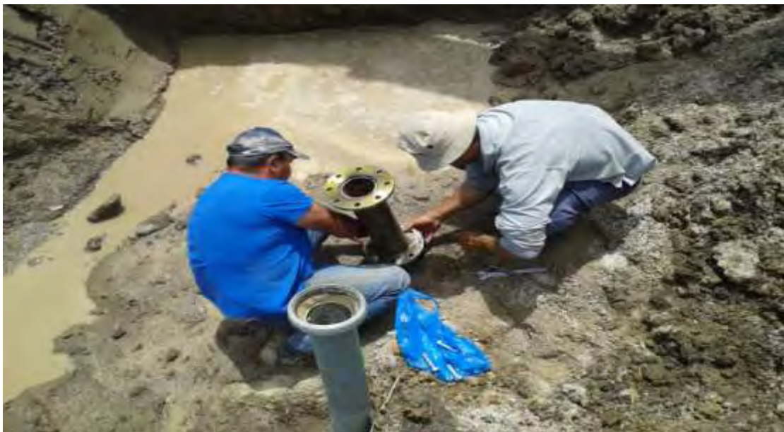
Εικόνα 5.21 βλαβη 9η διαρρηξη αγωγου στη ζώνη Σ3
