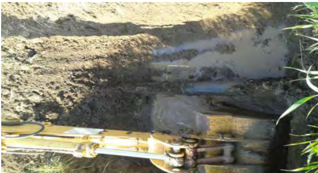
Εικόνα 5.15 βλαβη 3η διαρρηξη αγωγου στη ζώνη Σ4
