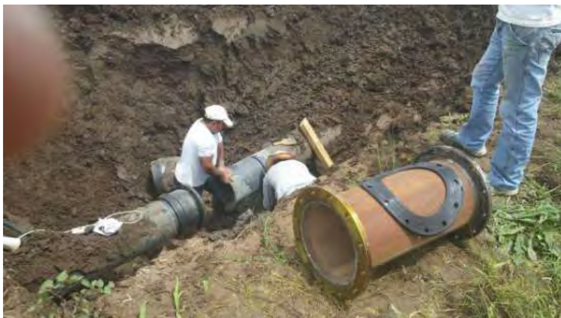
Εικόνα 5.35 βλάβη 9η διάρρηξη αγωγού στη ζώνη Σ4
