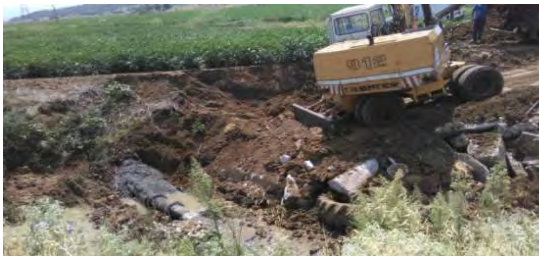
Εικόνα 5.38 βλάβη 12η διάρρηξη αγωγού στη ζώνη Σ2
