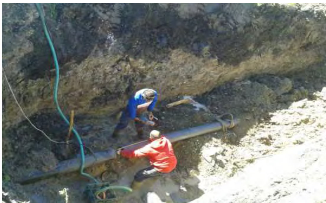
Εικόνα 5.32 βλάβη 6η διάρρηξη αγωγού στη ζώνη Σ3
