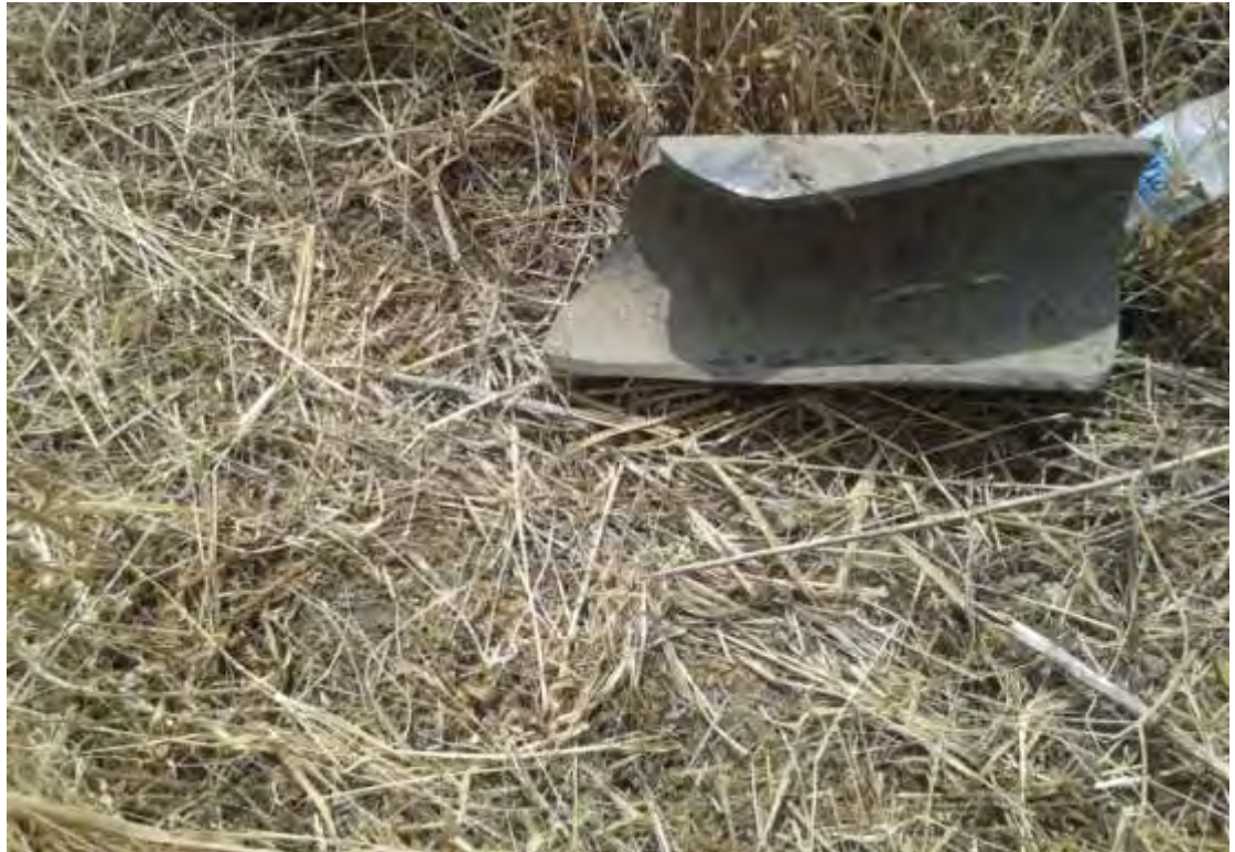
Εικόνα 5.36 βλάβη 10 η διάρρηξη αγωγού στη ζώνη Σ3
