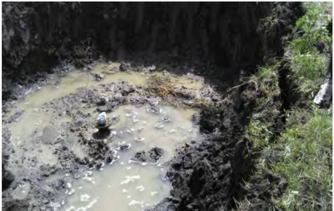
Εικόνα 5.37 βλάβη 11η διάρρηξη αγωγού στη ζώνη Σ4
