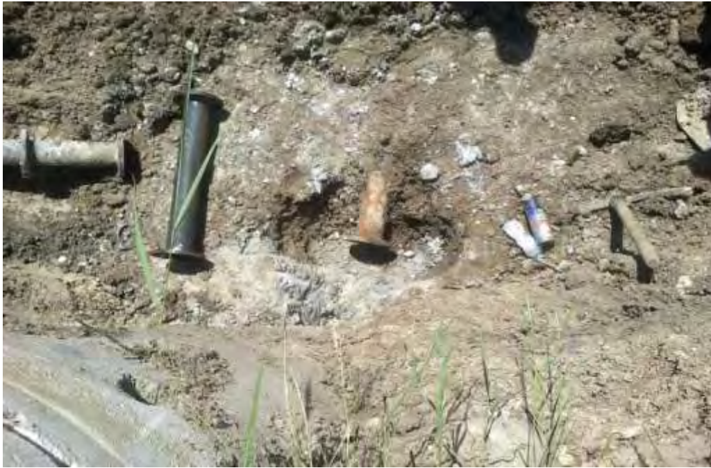
Εικόνα 5.6 βλαβη 6η σπασσιμο υδροληψειας στη ζώνη Σ2
