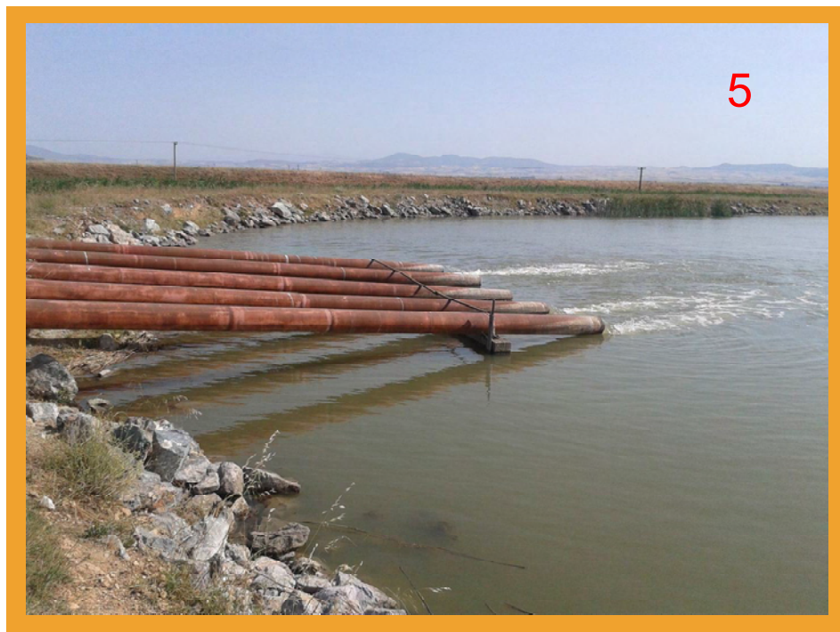
Εικόνα 4,5: Αντλιοστάσιο Ταμειυτήρα Καλαμακίου
