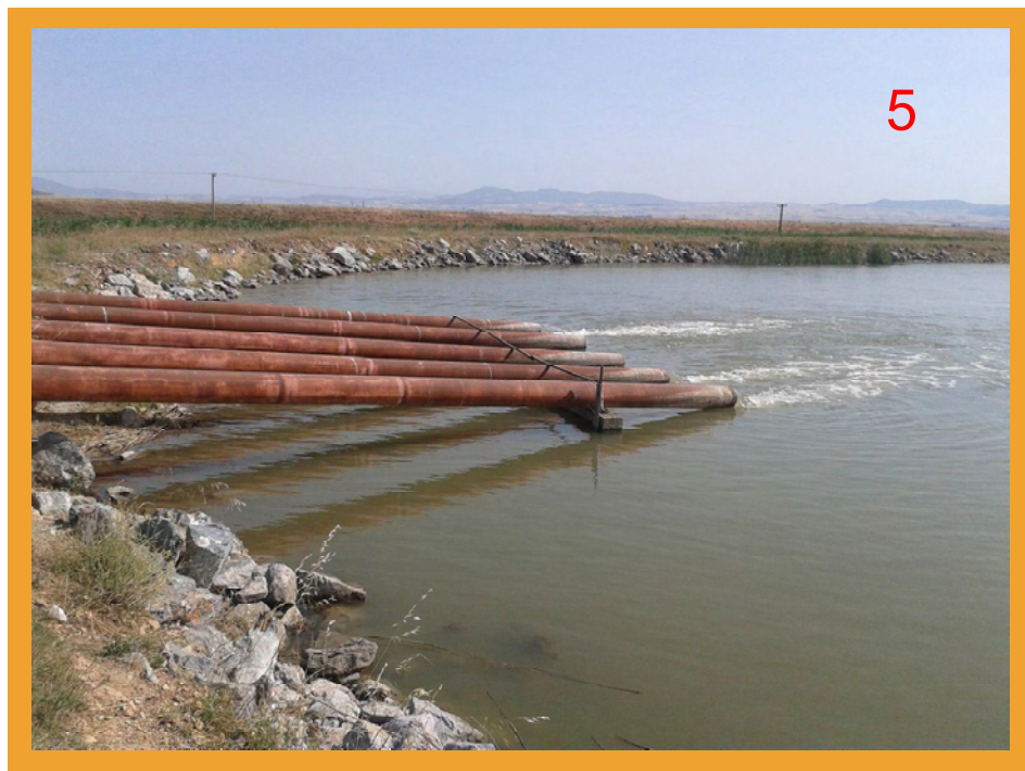
Εικόνα 4,5: Αντλιοστάσιο Ταμειυτήρα Καλαμακίου
