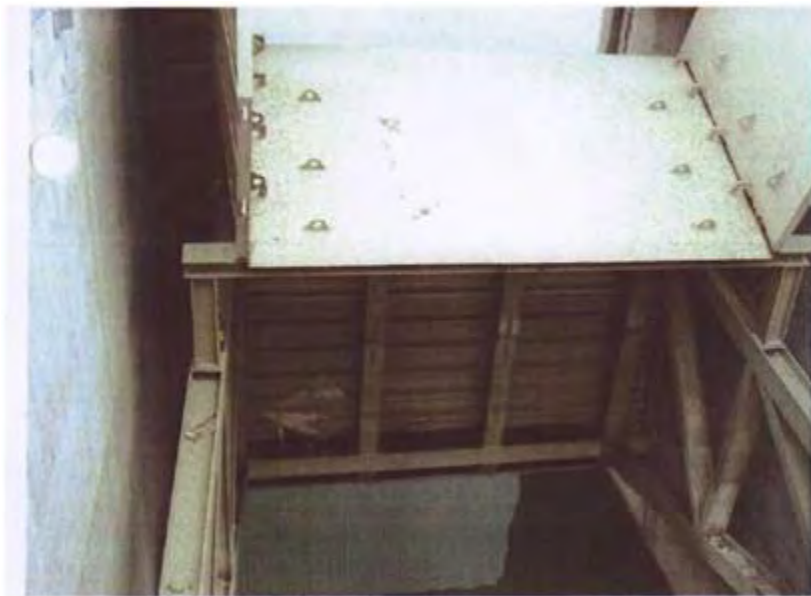
ΦΩΤ.6 ΑΠΟΨΗ ΤΩΝ ΘΥΡΟΦΡΑΓΜΑΤΩΝ ΚΑΙ ΜΗΧΑΝΙΣΜΟΥ ΛΕΙΤΟΥΡΓΙΑΣ
