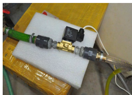
Εικόνα 3.10 Η ηλεκτροβαλβίδα του By-pass.
