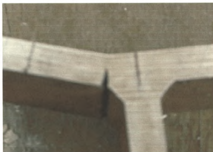
Σχήμα 3.4.2. Χαρακτηριστική ρωγμή που ξεκίνησε στη ρίζα της συγκόλλησης (κάτω σημείο διεπιφάνειας συγκόλλησης και μητρικού χάλυβα) παράλληλη με τη συγκόλληση.
