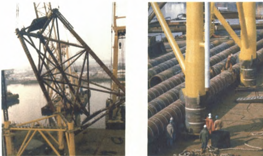
Σχήμα 2.4.8. Κατασκευή για την έδραση πλατφόρμας άντλησης καυσίμων όπου φαίνονται τα σωληνωτά μέλη της κατασκευής τα οποία καλύπτει ο API RP2A LRFD.
