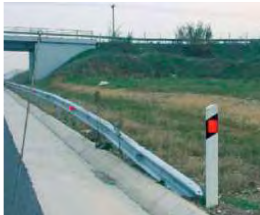
Μεταλλικά στηθαία ασφαλείας σε δεξιό άκρο ελληνικού αυτοκινητοδρόμου
