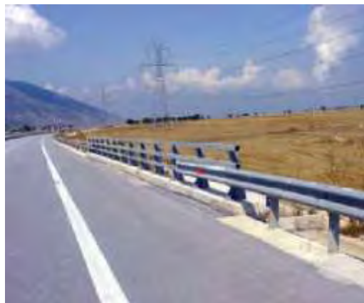
Ειδικά στηθαία ασφαλείας σε γέφυρα ελληνικού αυτοκινητοδρόμου
