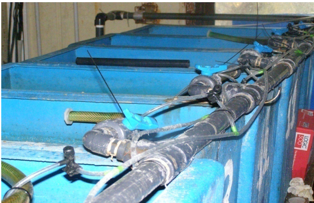
Εικόνα 4.1.: Σύστημα παροχής νερού και οξυγόνου στις πειραματικές δεξαμενές.
