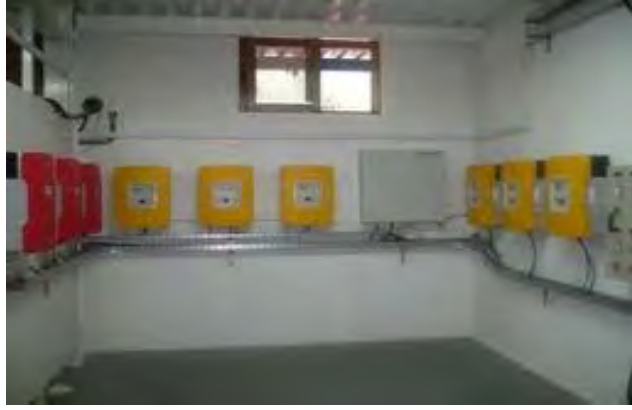
Εικόνα 1.4 Ομάδα αντιστροφών σε φωτοβολταϊκό πάρκο
