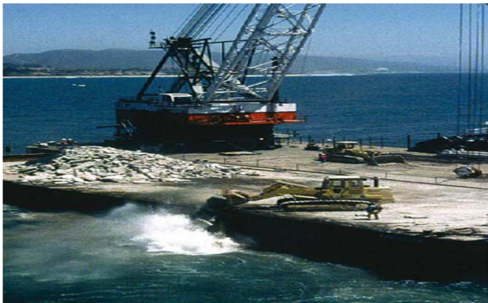
Εικόνα 4. Πόντιση φυσικών (κομμάτια βράχων) και τεχνητών υλικών (σκυρόδεμα) για την ανακούφιση υφάλων φαιοφυκών (Seaman, 2007).
