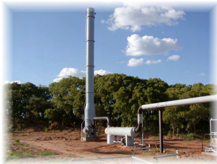
Εικόνα 3-12: Πυρσός καύσης βιοαερίου.
