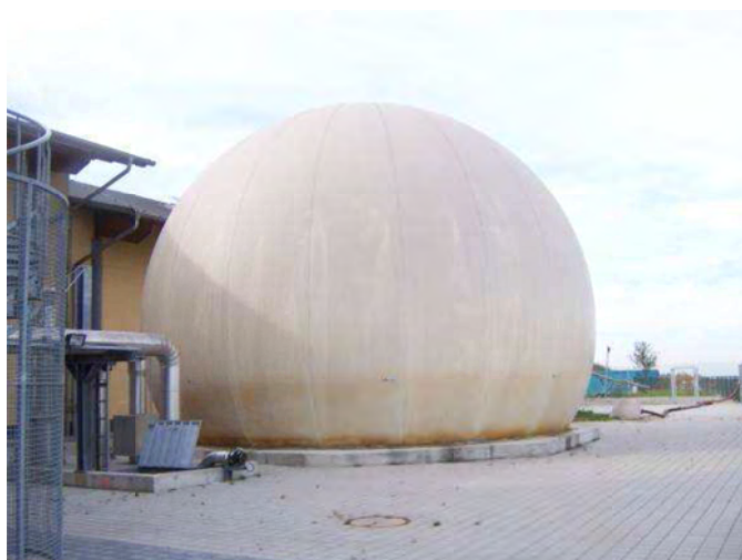
Εικόνα 3-8: Εξωτερική δεξαμενή αποθήκευσης βιοαερίου.
