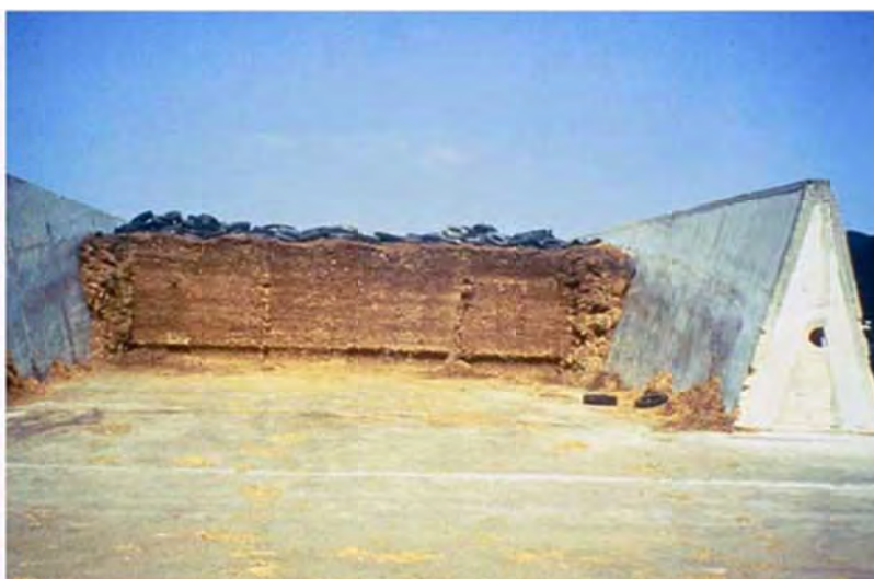
Εικόνα 3-2: Σιλό αποθήκευσης στερεών υποστρωμάτων.
