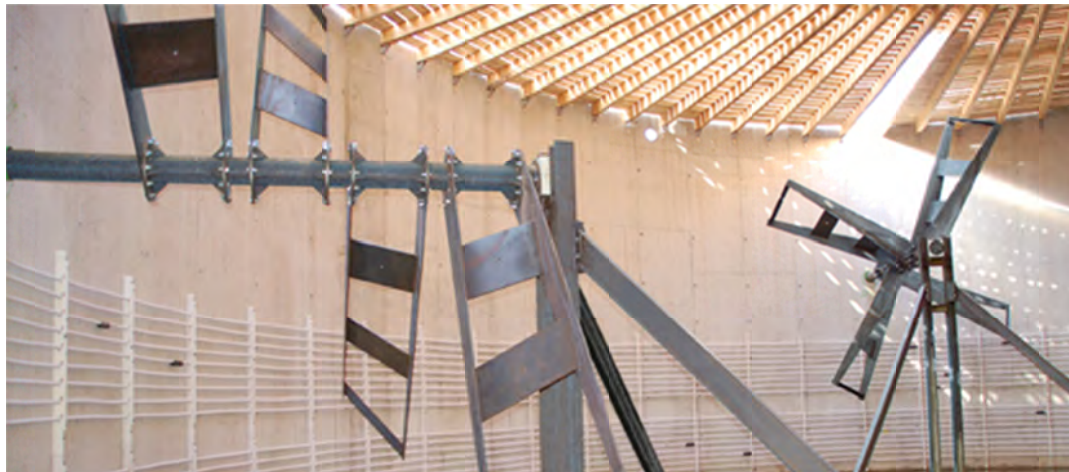
Εικόνα 3-7: Σύστημα μηχανικής ανάδευσης.
