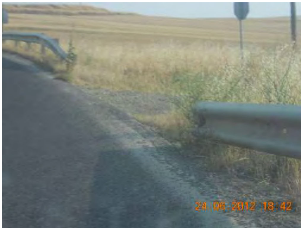
ΕΙΚΟΝΑ 4.3: Χ.Θ. 2+250 – Ισόπεδος κόμβος, ανεπαρκής σήμανση και διαγράμμιση
