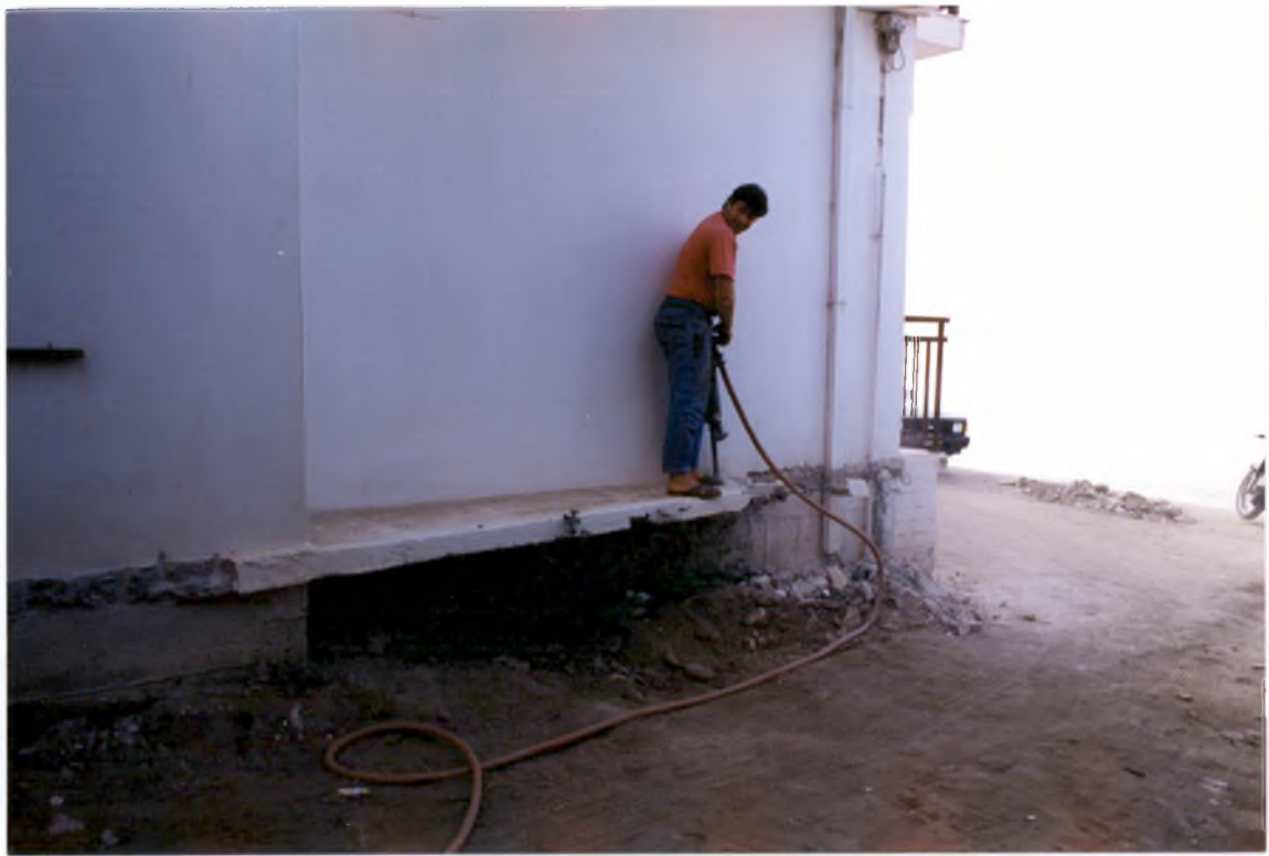
Φωτογραφία 3 : Γκρέμισμα του προεξέχοντος στοιχείου του κτιρίου για τη διάνοιξη της οδού
