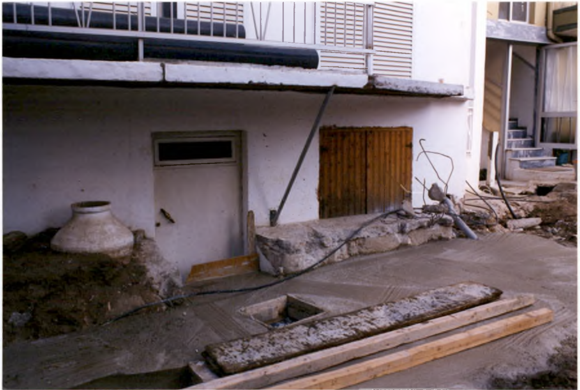
Φωτογραφία 5 : Έργα κατασκευής της οδού στο πυκνοδομημένο τμήμα. Μεγαλύτερη υποβίβαση του κτιρίου
