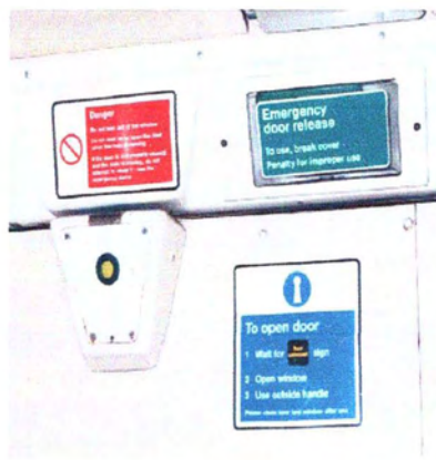
Φωτο 6. Χειρολαβή ανοίγματος θύρας
