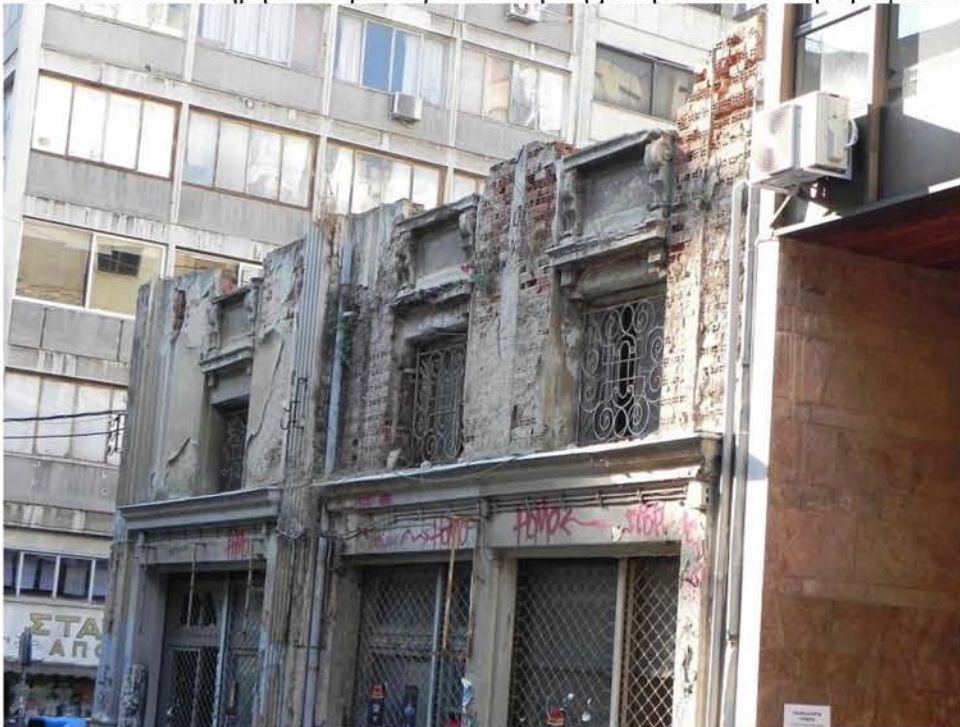
Εικόνα 4.16: Διατηρητέο κτίριο - ερείπιο στη συμβολή των οδών Βηλαρά με Καθολικών
