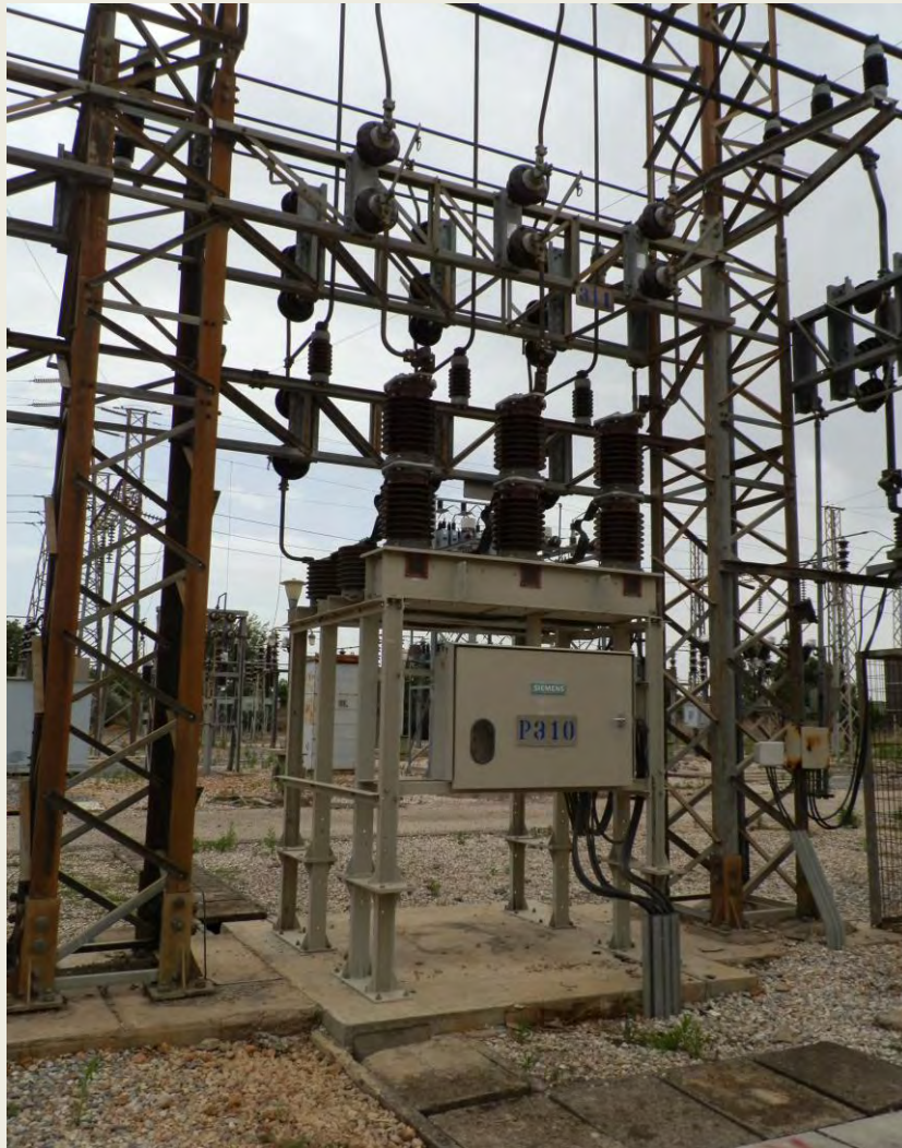
Εικόνα 23: Διακόπτης ισχύος SF 6 στον Υ/Σ Οινοφύτων[1]
