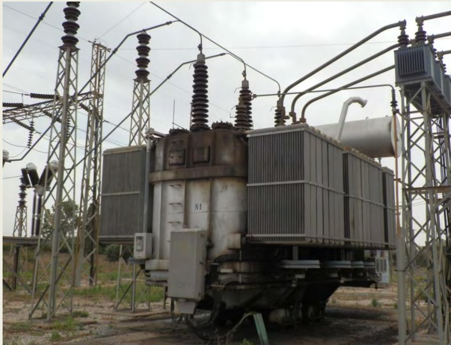
Εικόνα 17:Μετασχηματιστής με μόνωση λαδιού στον Υ/Σ Οινοφύτων[1]
