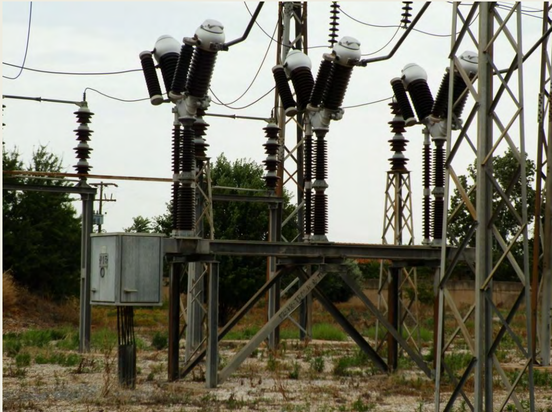
Εικόνα 21: Διακόπτες ισχύος πτωχού ελαίου στον Υ/Σ Οινοφύτων[1]
