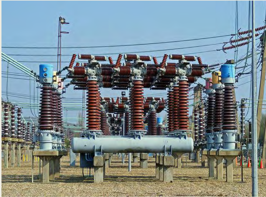
Εικόνα 19: Διακόπτης ισχύος αέρος, τάσης 275kV[20]
