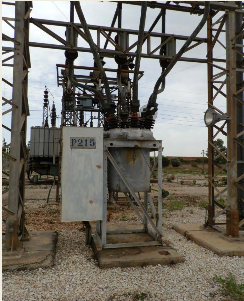
Εικόνα 20: Διακόπτης ισχύος λαδιού στον Υ/Σ Οινοφύτων[1]
