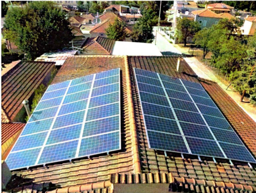
Εικόνα 1.9 Φωτοβολταϊκό σύστημα 9,87 kWp αποτελούμενο από πάνελ πολυκρυσταλλικού πυριτίου σε οροφή στη Λάρισα.
