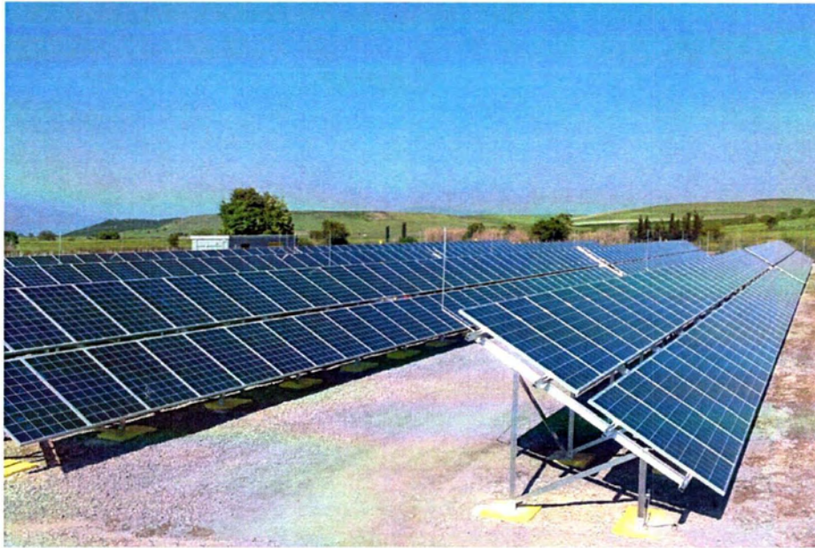
Εικόνα 3.13 Εγκατάσταση σταθερών Φ/Β συλλεκτών ισχύος 99,84 kWp.
