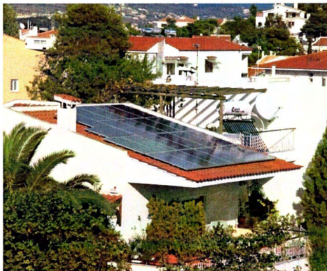
Εικόνα 1.8 Φωτοβολταϊκό σύστημα 4,83 kWp εγκατεστημένο σε στέγη κατοικίας στην Παλλήνη.
