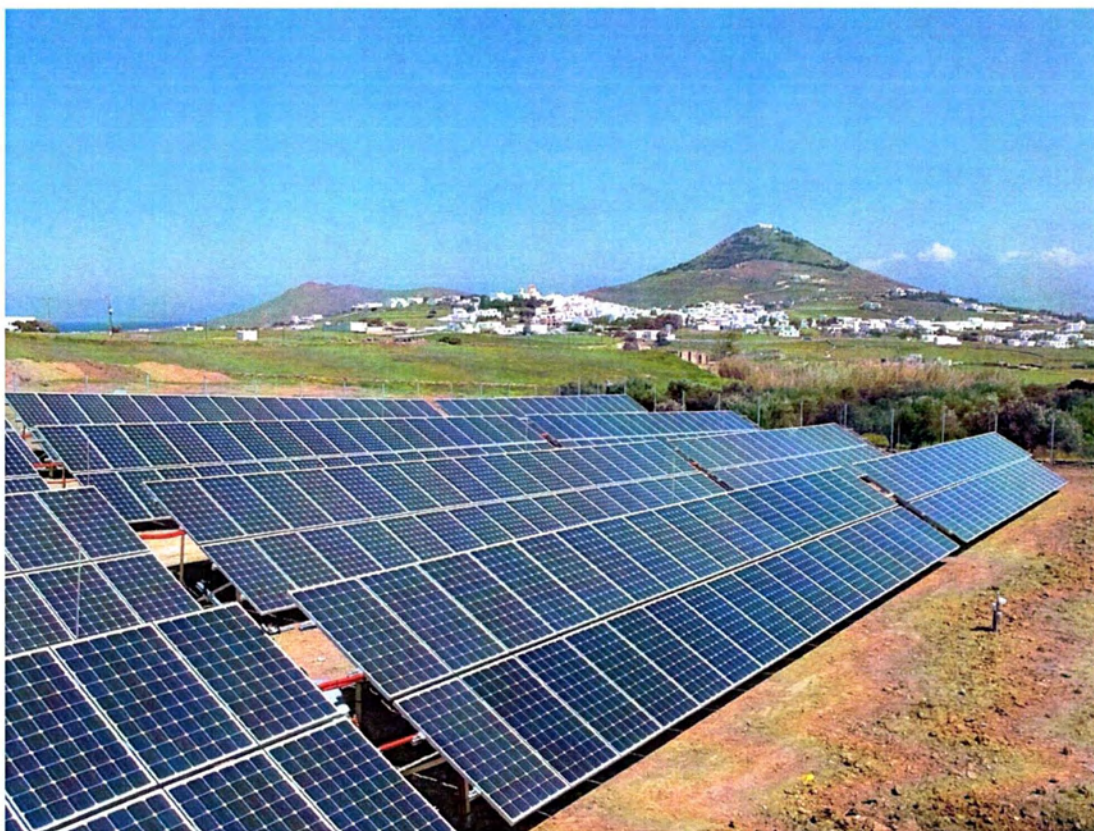
Εικόνα 1.6 Φωτοβολταϊκός σταθμός ισχύος 99.36 kWp αποτελούμενος από 414 μονοκρυσταλλικά πλαίσια στη Πάρο.
