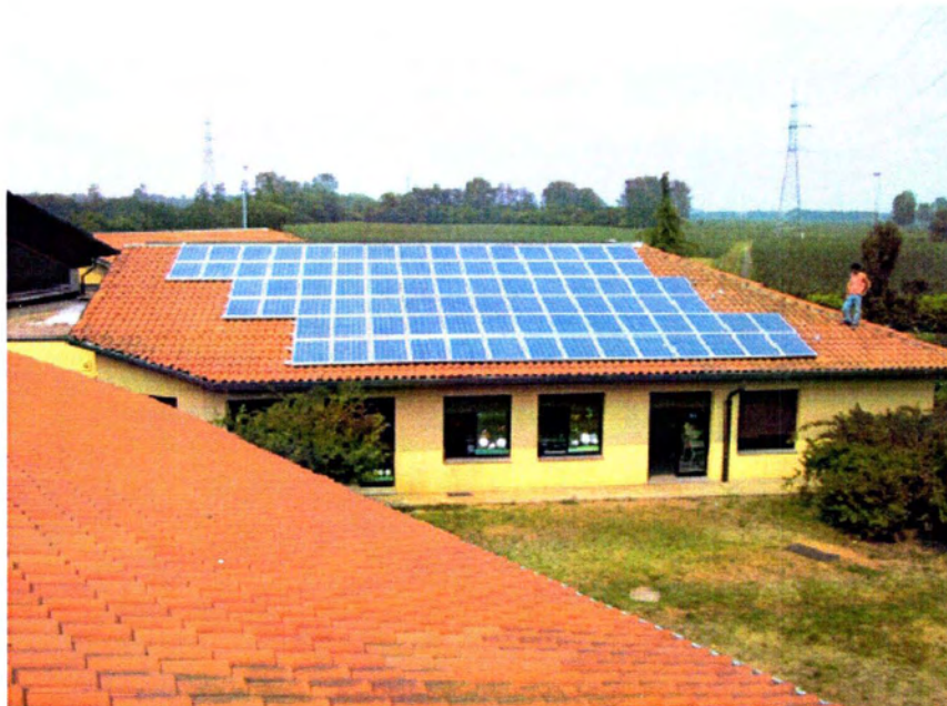
Εικόνα 3.22 Διασυνδεδεμένο φωτοβολταϊκό σύστημα ισχύος 9 kWp.
