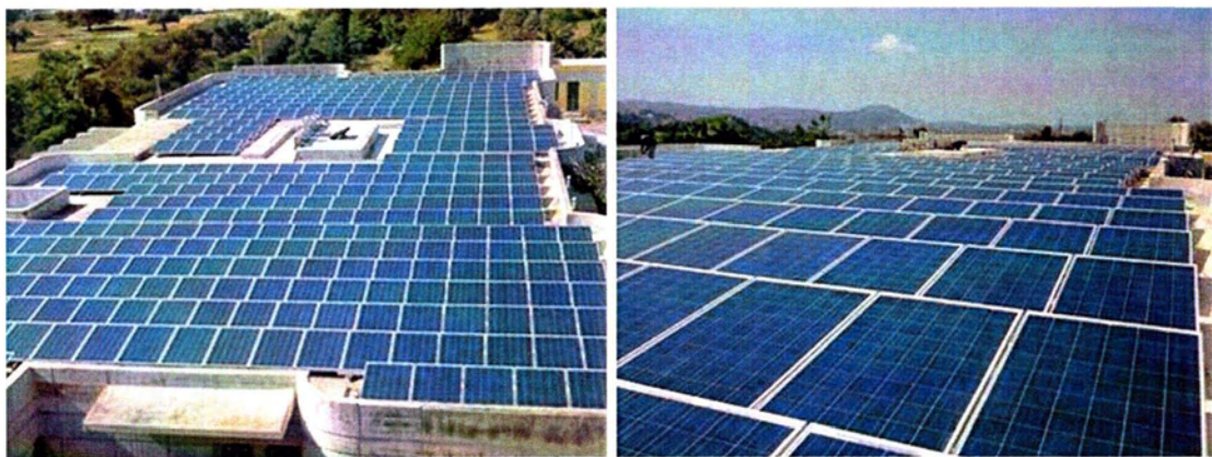
Εικόνα 1.5 Φωτοβολταϊκή εγκατάσταση 100 kWp σε βιομηχανική στέγη στη Ρόδο.
