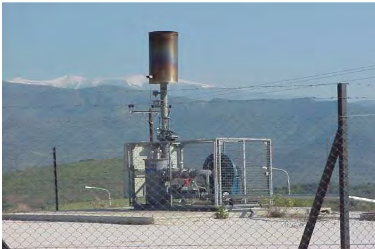
Φωτογραφία 10: Πυρσός καύσης του βιοαερίου
