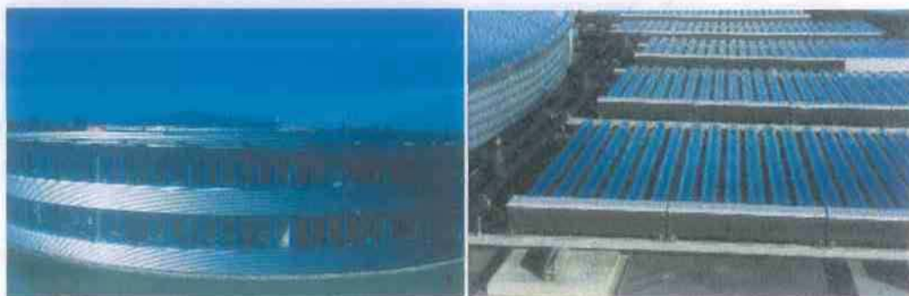
Εικόνα 6.2- α) πρόσοψη κτιρίου, β) εγκαταστάσεις των ηλιακών συλλεκτών κενού (πηγή: Ott & Spiess Langenau)
