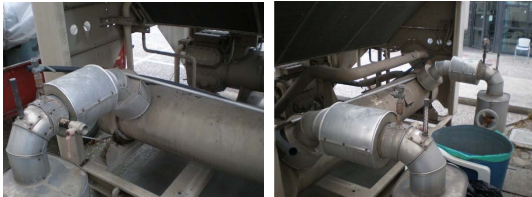
Εικόνα 91. Πίσω όψη ψυκτικής μονάδας. Διακρίνονται ο εξατμιστήρας και η είσοδος και έξοδος του νερού ψύξης
