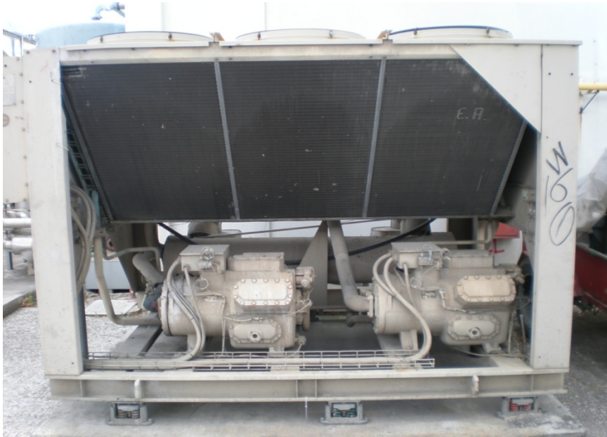
Εικόνα 87. Όψη ψυκτικής μονάδας TRANE CGAF 211R. Διακρίνονται οι δύο συμπιεστές και ο συμπυκνωτής
