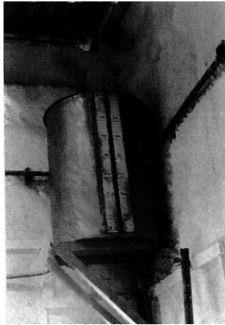
10. Δεξαμενή ημερήσιας κατανάλωσης πετρελαίου
