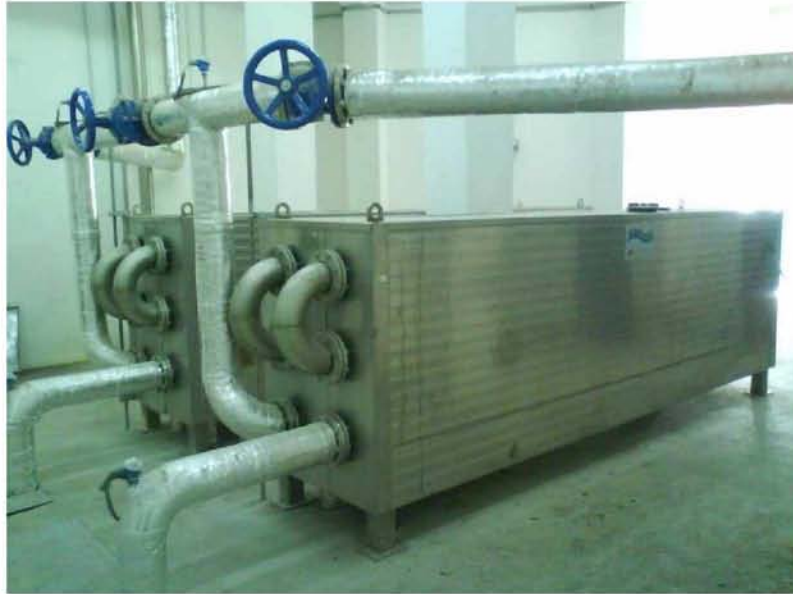
Εικόνα 4.33: Εναλλάκτης θερμότητας λάσπης για την ρύθμιση της θερμοκρασίας στο εσωτερικό του χωνευτή.
