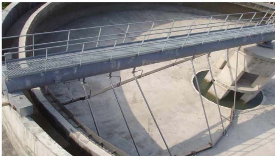
Εικόνα 4.14 Δεξαμενή πρωτοβάθμιας καθίζησης.
