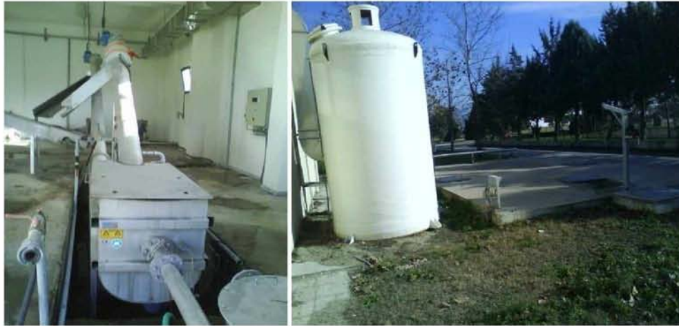
Εικόνα 4.3 – 4.4: Μονάδα επεξεργασίας βοθρολυμάτων και φίλτρο απόσμησης στην ΕΕΑ Λάρισας.
