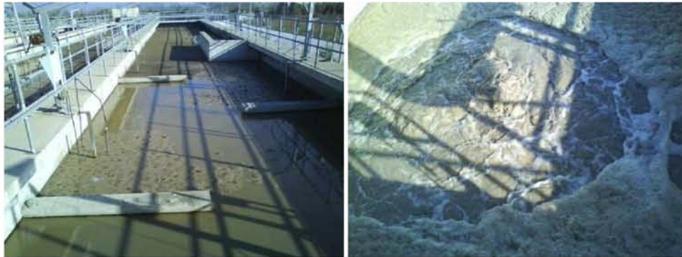
Εικόνα 4.17 – 4.18: Μονάδα αερισμού στην ΕΕΛ Λάρισας.
