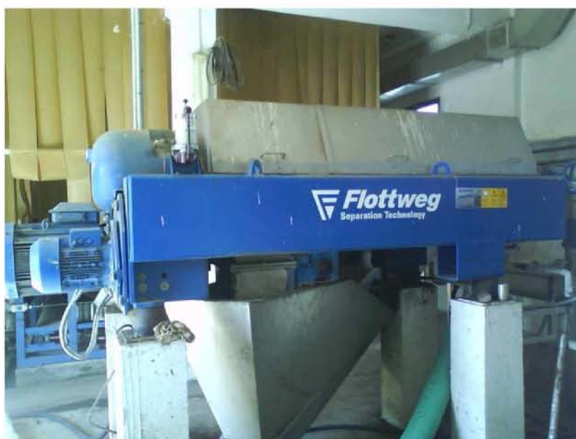
Εικόνα 4.35: Μονάδα μηχανικής αφυδάτωσης στην ΕΕΛ Λάρισας.
