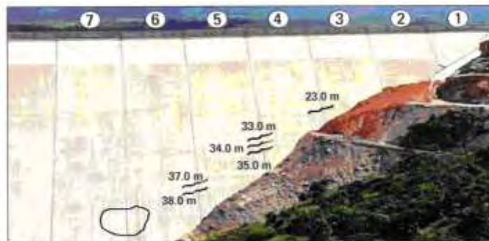
Εικ. 18: Itapetí: η θέση των ρωγμών στις πλάκες από σκυρόδεμα
