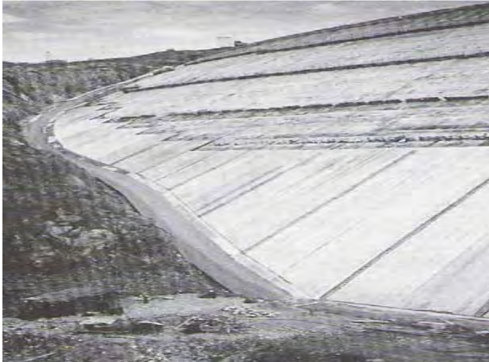
Εικ. 13: Υπό κατασκευή στεγανοποίηση πλάκας σκυροδέματος. (πλάκες πλίνθου σε οριζόντια διάρθρωση κατασκευής και μεταβατική στρώση καλύμματος από σκυρόδεμα)
