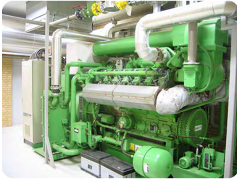
Εικόνα 9: Μονάδα συμπαραγωγής ηλεκτρισμού και θερμότητας. (Πηγή: http://envima.gr/el/biogas_plants/fotografies_stoixeiwn_egkatashtsis_bioaeriou )
