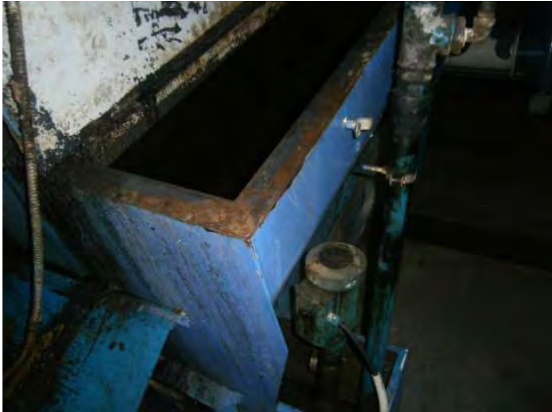
Εικόνα 20: Αντλία λίπους και δεξαμενή διαχωρισμού στερεών – υγρών.
