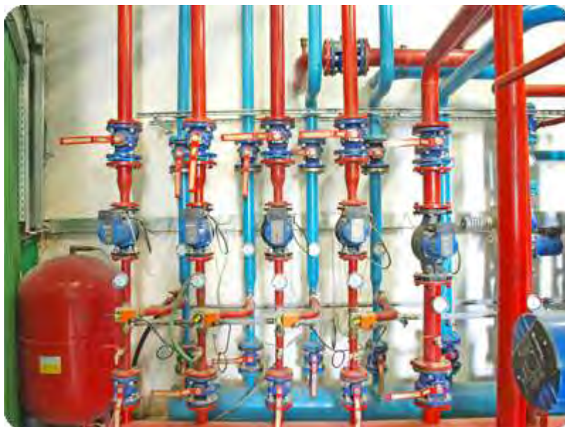
Εικόνα 46: Σύστημα θέρμανσης. (Πηγή:
