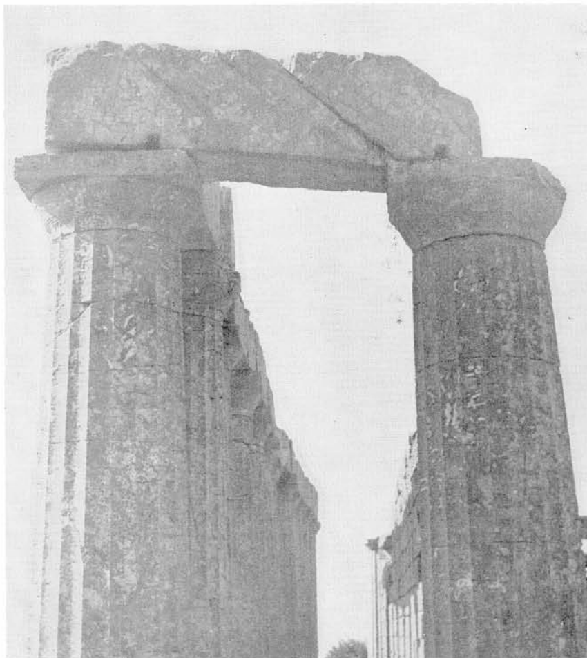
Ἡλεία. Ναός Ἐπικουρίου Ἀπόλλωνος Βασσῶν : α. Τὸ ἐτοιμόρροπον ἐπιστύλιον κατὰ τὴν ἀνατολικὴν πλευρὰν τοῦ ναοῦ μετὰ τοῦ αὐτόθι ἐτοιμορρόπου κιονοκράνου, β. Τὸ ἐτοιμόρροπον ἐπιστύλιον παρὰ τὴν ΒΑ. γωνίαν τῆς βορείας πλευρᾶς τοῦ ναοῦ μετὰ τοῦ δευτέρου ἀπὸ τῆς αὐτῆς γωνίας κίονος πρὸ τῆς ἀποκαταστάσεως αὐτῶν
