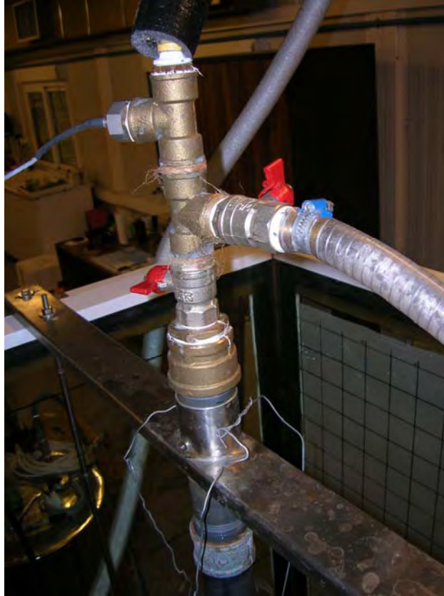
Σχήμα 2.6(b) ΤΑΥ σύνδεσης παρακαμπτήριου σωλήνα και συσκευής τροφοδοσίας της φλέβας με το δίκτυο. Διακρίνεται το θερμοστοιχείο ταχείας απόκρισης.
