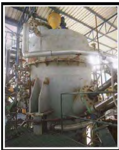
Εικόνα 21 Εγκατάσταση αεριοποίησης (Φάττα,2007)
