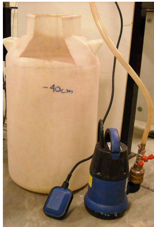
Σχήμα 3.5 Δεξαμενή παρασκευής διαλύματος & βυθιζόμενη αντλία
